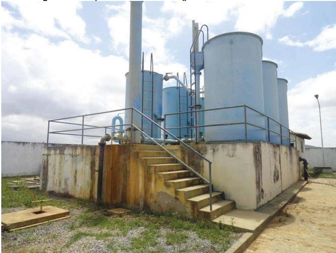
Figura 18: Estação de Tratamento de Água da DESO em Tobias Barreto
