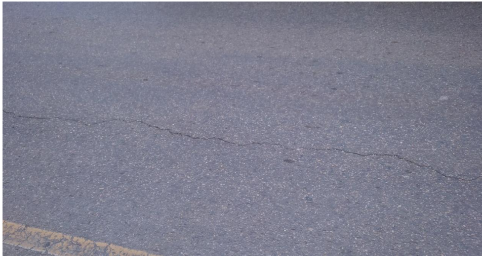
Figura 10: Trinca Isolada Longitudinal
