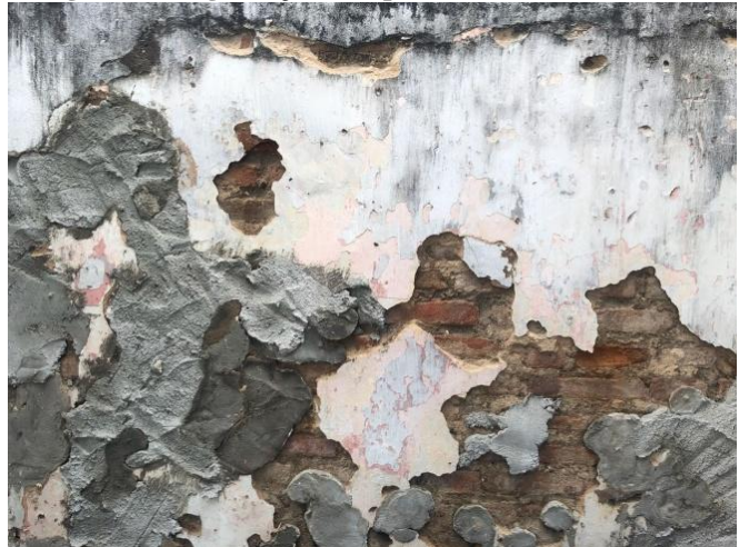
Figura 6 - Degradação das paredes laterais externas.
