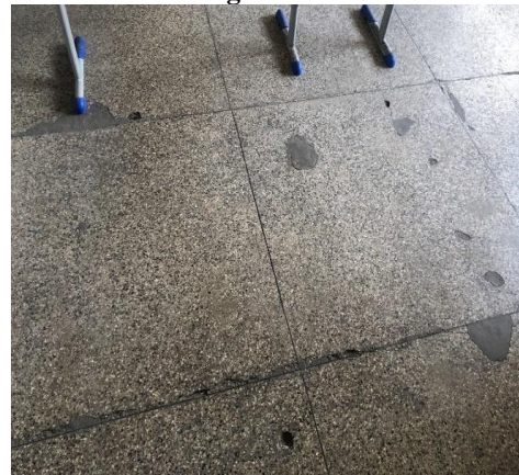
Figura 13 - Piso com fissuras revestida de argamassa.
