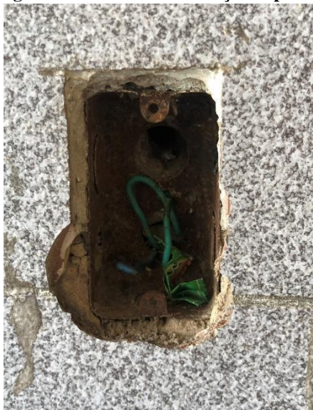
Figura 23 - Tomado com fiação exposta.
