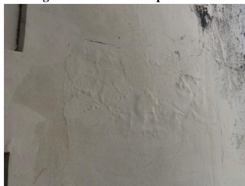
Figura 28 - Parede na parte lateral
