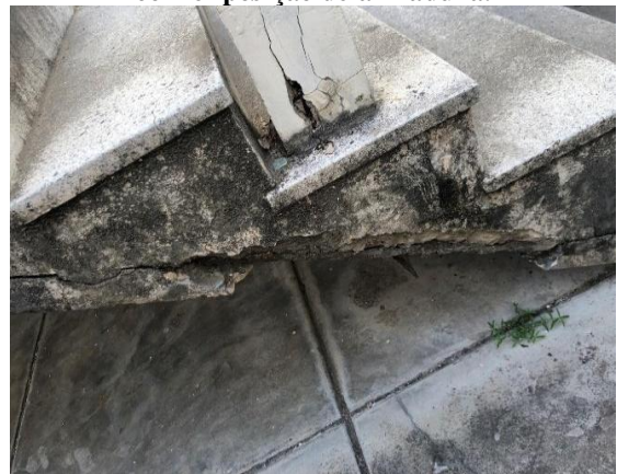
Figura 8 - Escada de acesso ao andar superior com exposição de armadura.
