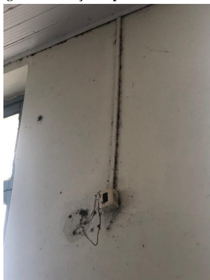
Figura 24 - Fiação exposta do ventilador.
