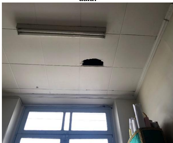
Figura 14 - Placa de gesso quebra na sala de aula.
