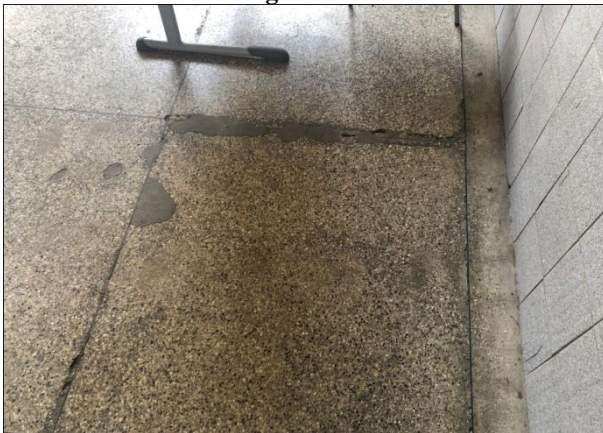
Figura 12 - Piso com fissuras revestida de argamassa.
