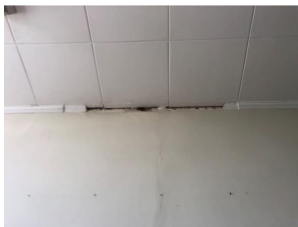
Figura 15 – Junta de dilatação quebrada.
