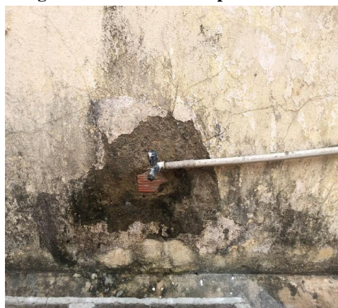
Figura 26 - Torneira na parte externa
