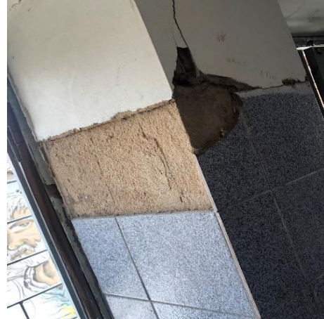
Figura 11 - Deslocamento do revestimento na sala de aula.
