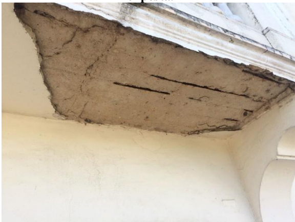
Figura 7 - Varanda da fachada com armadura exposta.
