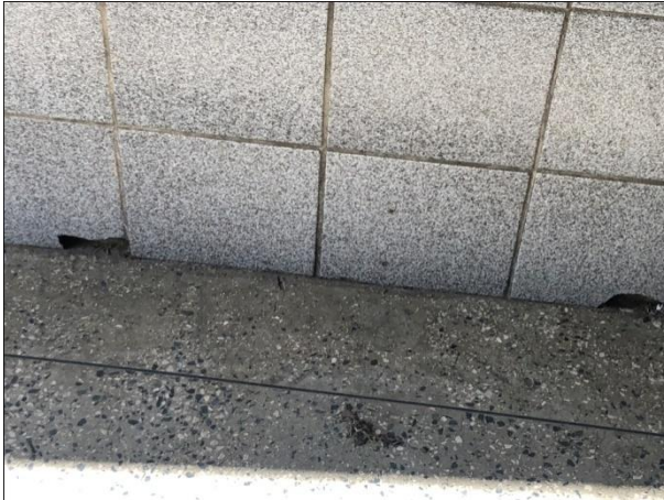
Figura 10 - Revestimento quebrado em um dos corredores internos.
