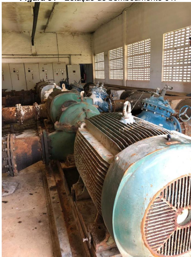
Figura 31 - Estação de bombeamento 01.
