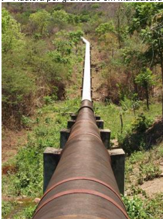
Figura 17 - Adutora por gravidade em Mandacaru da Serra.
