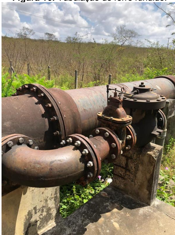
Figura 16: Tubulação de ferro fundido.
