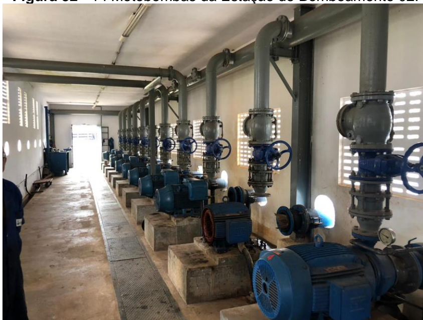
Figura 32 - 14 Motobombas da Estação de Bombeamento 02.
