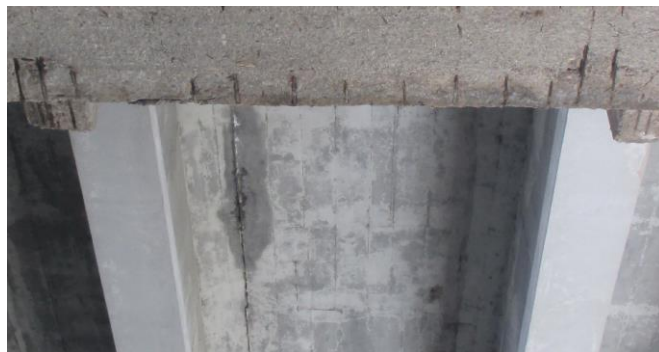
Figura 30: Fissura possibilitando a passagem de água da superfície
