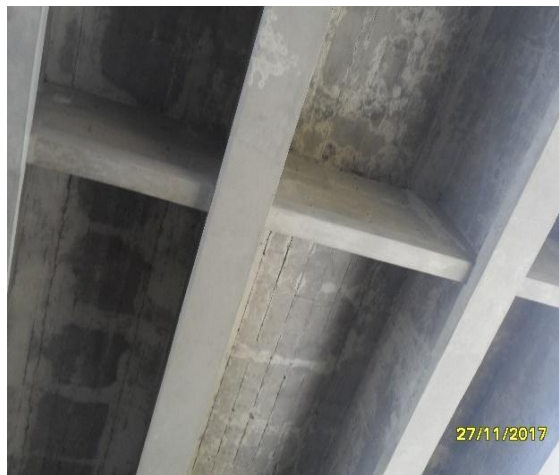
Figura 35: Eflorescência na laje
