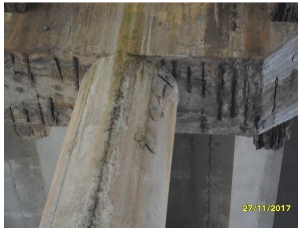
Figura 25: Corrosão no topo do pilar da infraestrutura
