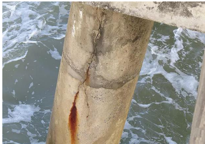
Figura 18: Fissura causada pela corrosão da armadura
