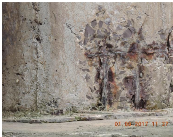
Figura 37: Segregação no pilar
