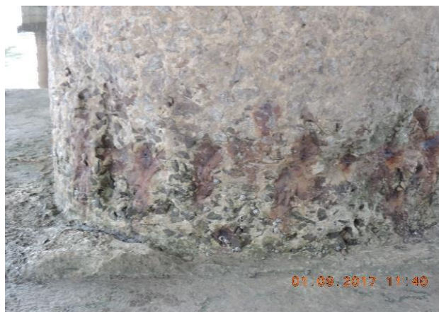
Figura 36: Segregação na base do pilar
