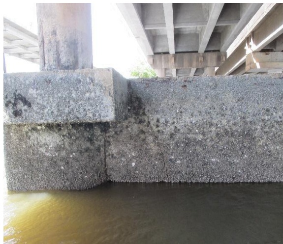
Figura 28: Fissura de flexão entre viga e apoio.
