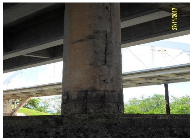
Figura 26: Corrosão no meio do pilar da infraestrutura
