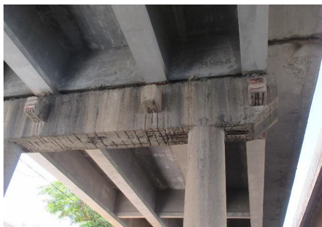
Figura 22: Corrosão da viga na mesoestrutura
