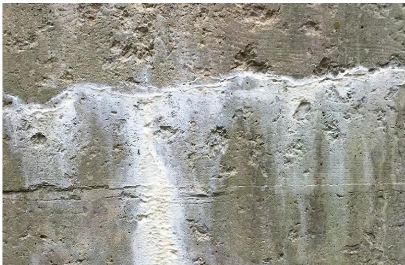
Figura 21: Sais em superfície de concreto
