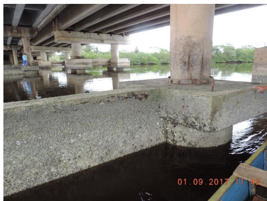
Figura 29: Fissura entre viga e apoio
