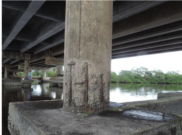
Figura 24: Corrosão do pé do pilar na infraestrutura
