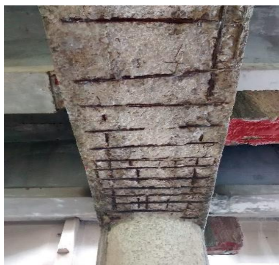
Figura 23: Corrosão acentuada em viga na mesoestrutura
