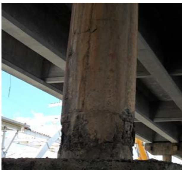
Figura 16: Desagregação do concreto na base do pilar
