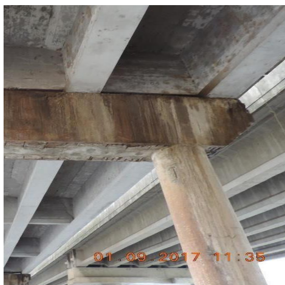
Figura 34: Eflorescência no pilar
