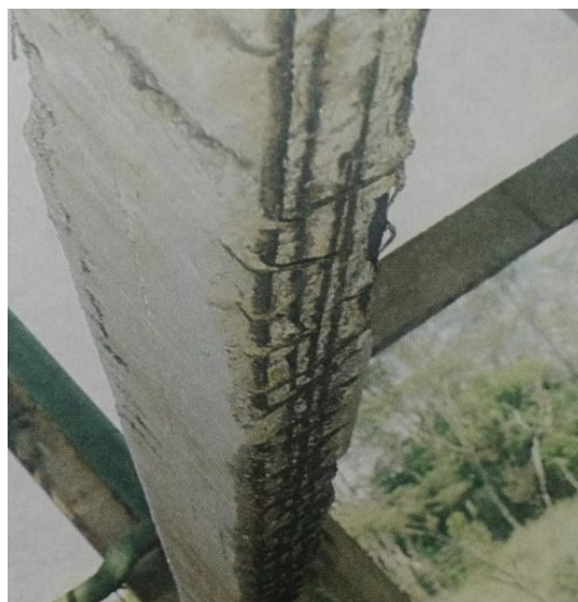
Figura 19: Corrosão da armadura em estado avançado de deterioração
