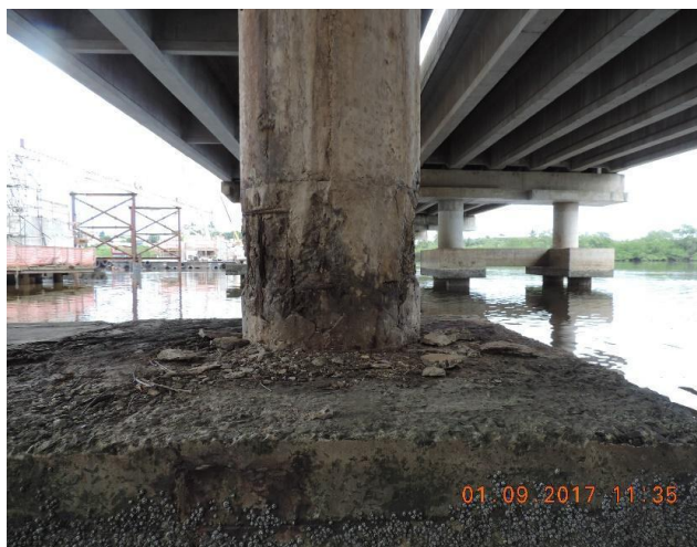
Figura 32: Desagregação na base do pilar
