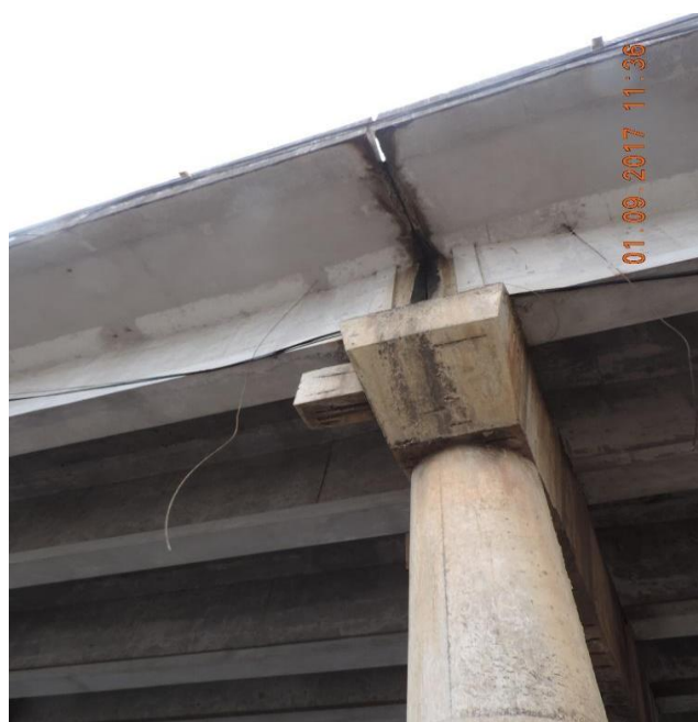
Figura 31: Junta com infiltração
