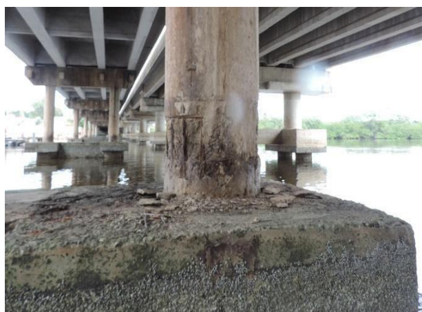
Figura 33: Desagregação na base do pilar
