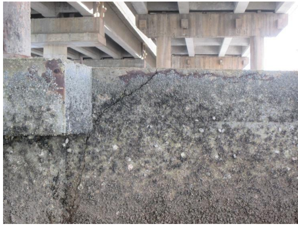
Figura 27: Fissura de cisalhamento entre viga e apoio.
