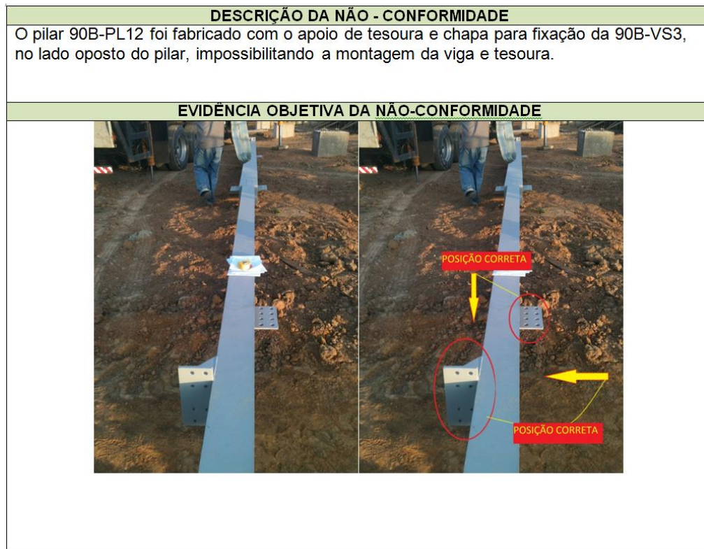
Figura 23: Exemplo de RNC com posicionamento incorreto de elementos nas peças
