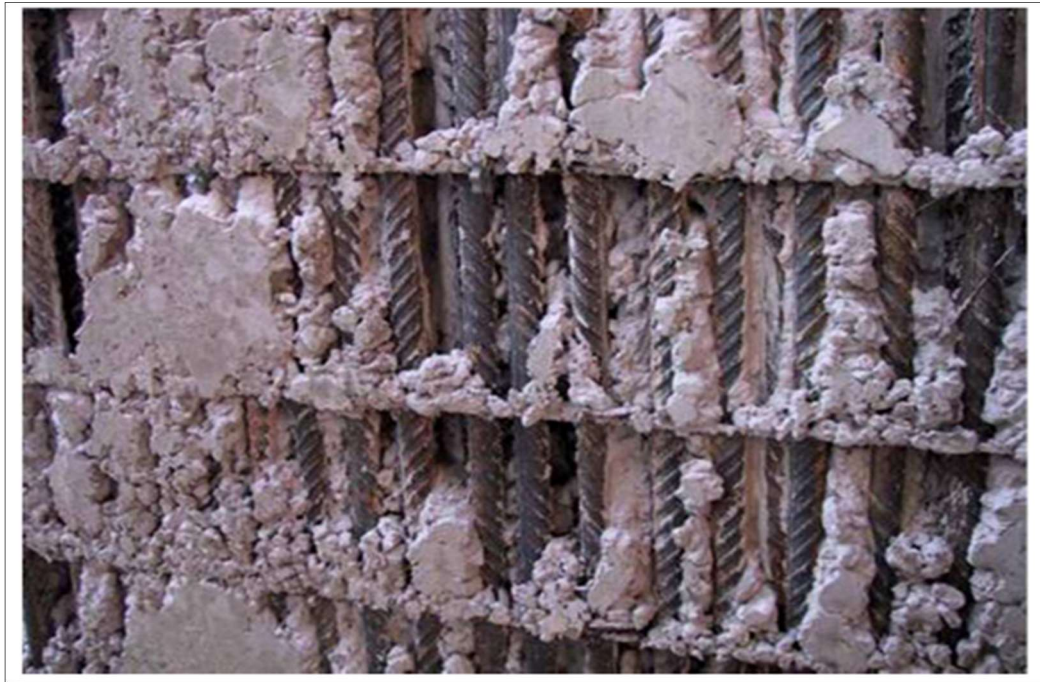
Figura 7 - Segregação do concreto.
