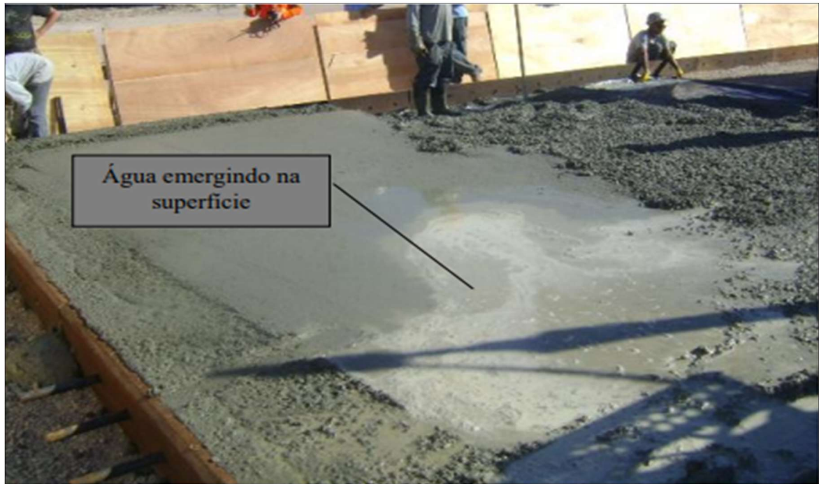
Figura 8 - Exsudação na superfície do concreto recém lançado.
