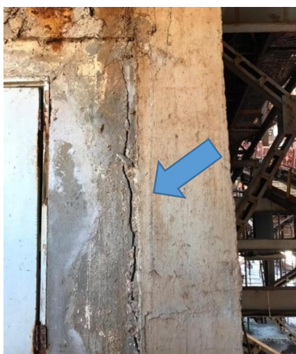
Figura 28: Fissura no concreto armado, subestação 01-22
