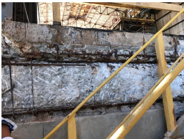
Figura 24: Corrosão de armadura na viga, subestação 01-22 Fonte: Arquivo pessoal (2018)
