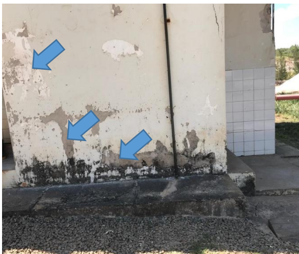
Figura 32: Desgaste do concreto e destacamento da pintura, subestação 01-22 Fonte: Arquivo pessoal (2018)
