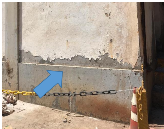
Figura 34: Destacamento da pintura, subestação 01-22 Fonte: Arquivo pessoal (2018)
