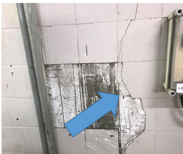
Figura 30: Fissura e destacamento de revestimento cerâmico, subestação 01-22 Fonte: Arquivo pessoal (2018)
