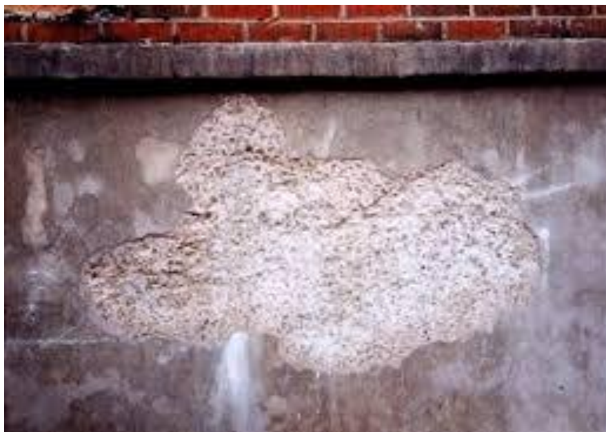
Figura 8: Desgaste do concreto Fonte: Junior (2013)
