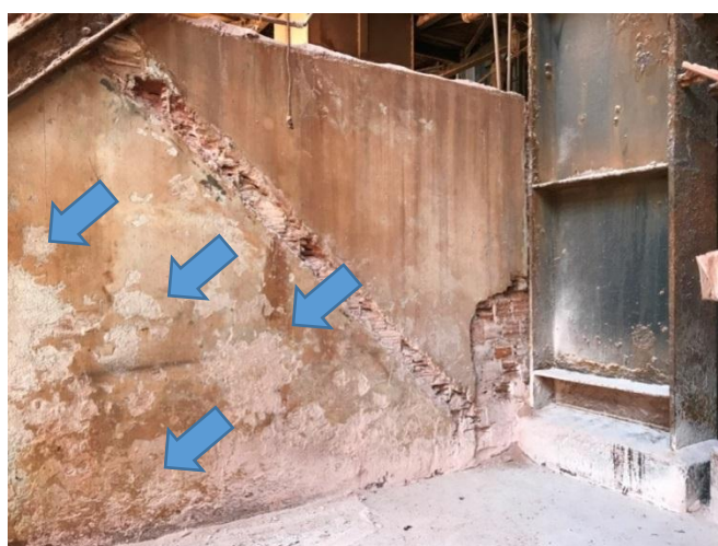
Figura 31: Desgaste no concreto, subestação 01-22 Fonte: Arquivo pessoal (2018)
