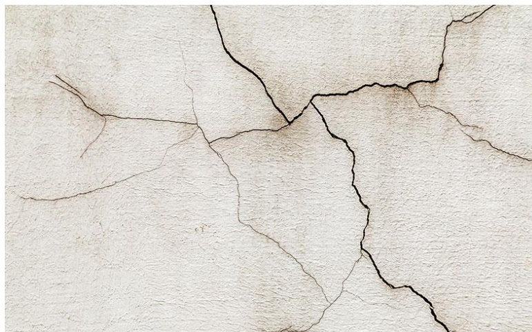
Figura 6: Fissuras Fonte: Noal (2018)
