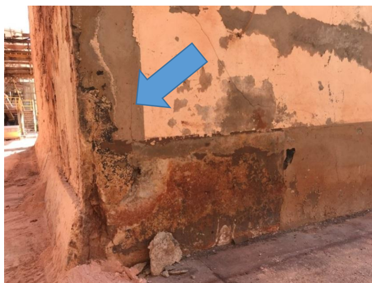
Figura 26: Desagregação do concreto e corrosão da armadura, subestação 02-21
