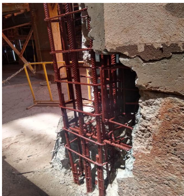
Figura 39: Manutenção da desagregação do concreto e corrosão da armadura, subestação 02-21
