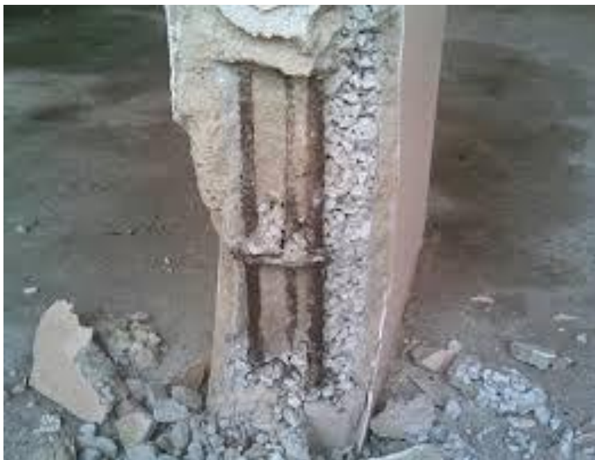
Figura 7: Desagregação de concreto em pilar Fonte: AsaServ (2014)
