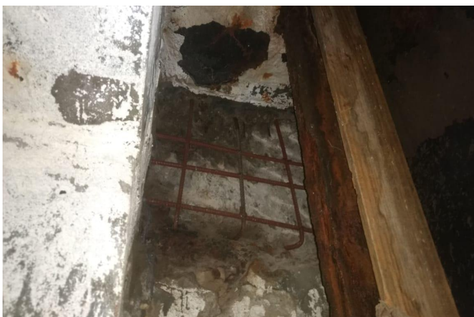
Figura 23: Corrosão de armadura do pilar, subestação 01-22
