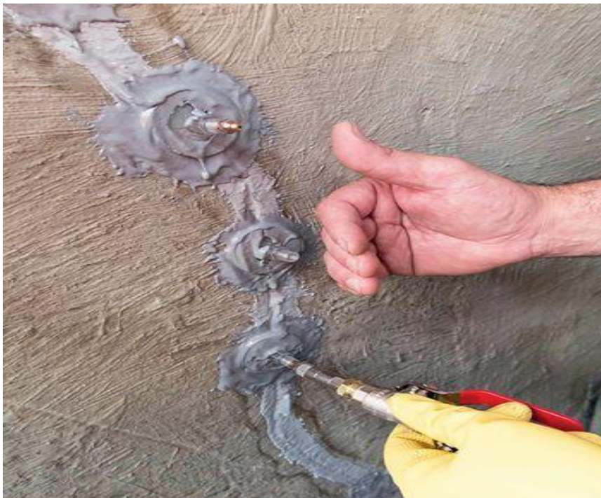
Figura 16: Injeção de fissuras Fonte: Figuerola (2014)
