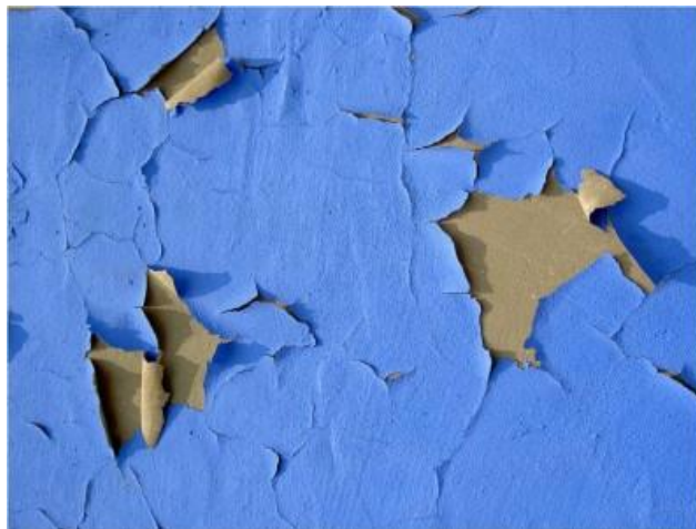
Figura 11: Descascamento de pintura Fonte: Mãos à Obra (2013)
