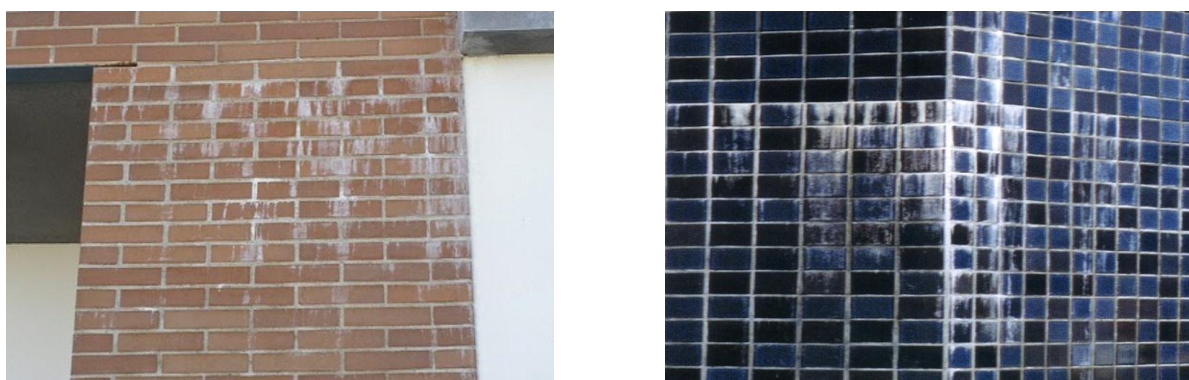
Figura 3: Eflorescência revestimento Fonte: Global Locações (2016); Ribeiro (2012)
