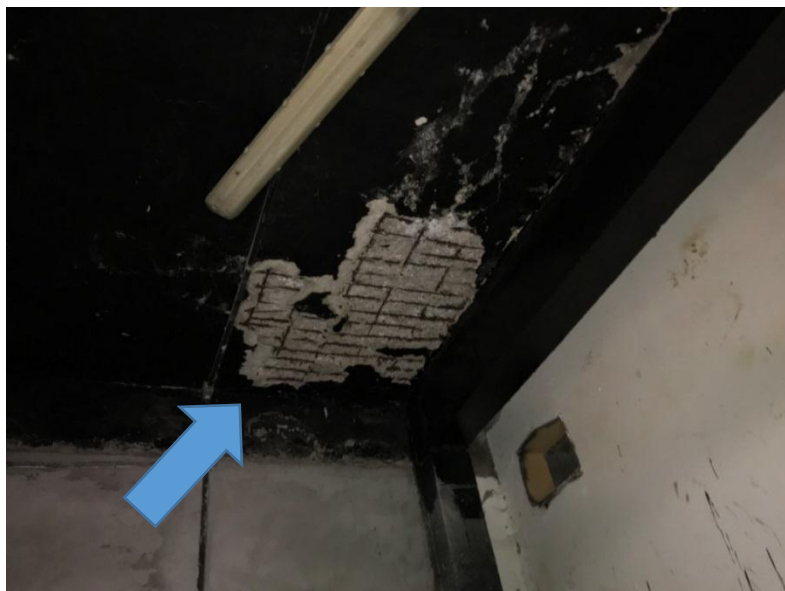
Figura 27: Desagregação do concreto e corrosão da armadura, subestação 01-22
