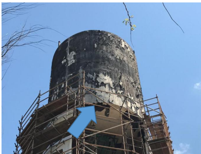
Figura 33: Destacamento da pintura, caixa d'água Fonte: Arquivo pessoal (2018)
