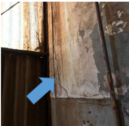
Figura 29: Fissura no concreto armado, subestação 01-22 Fonte: Arquivo pessoal (2018)
