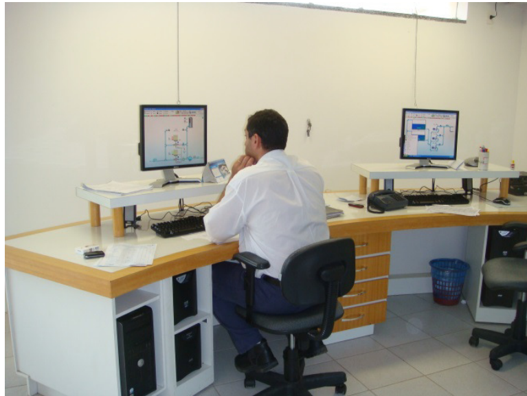
Figura 10 – Centro de Controle Operacional: vista interior
