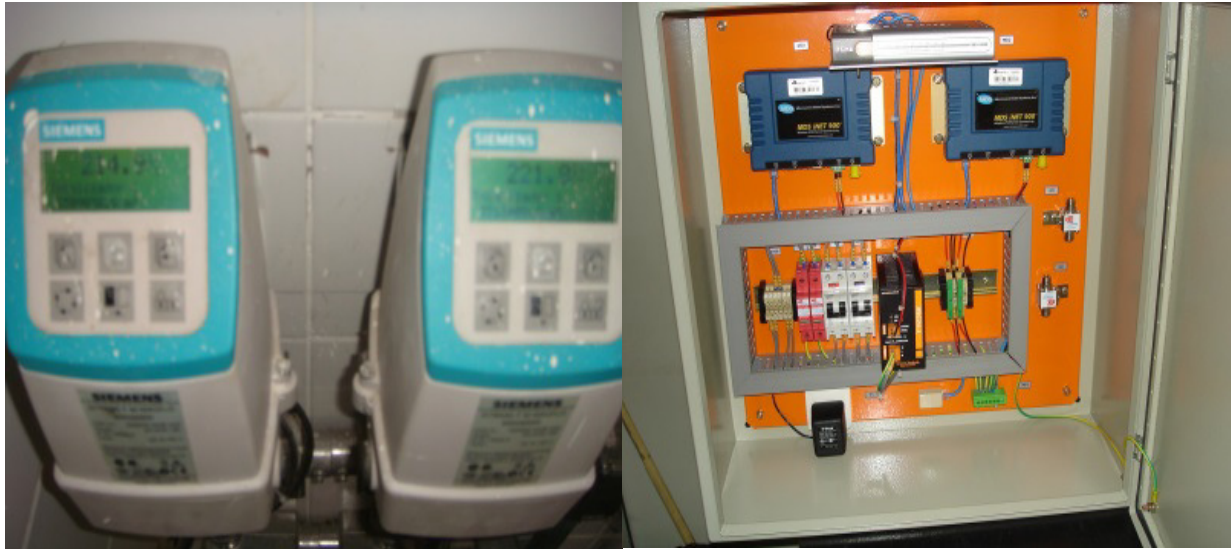
Figura 16 – Indicador local dos medidores de vazão e inspeção de fabricação das Unidades Terminais Remotas UTR`s
