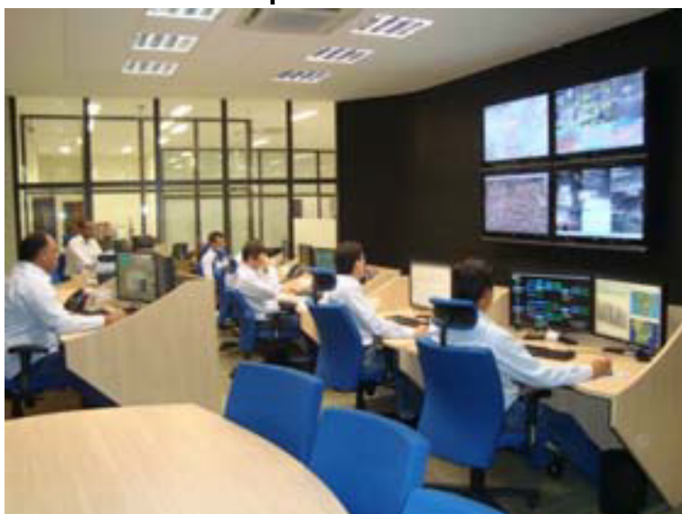
Figura 4 – Centro de Controle Operacional com Sistema SCADA
