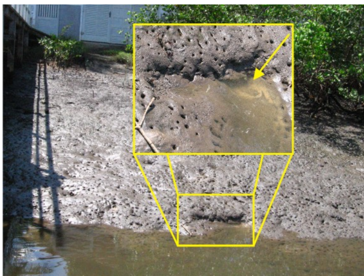
Figura 22: Esgotamento sanitário camuflado, lançando efluentes no rio Santa Maria, 2008.
