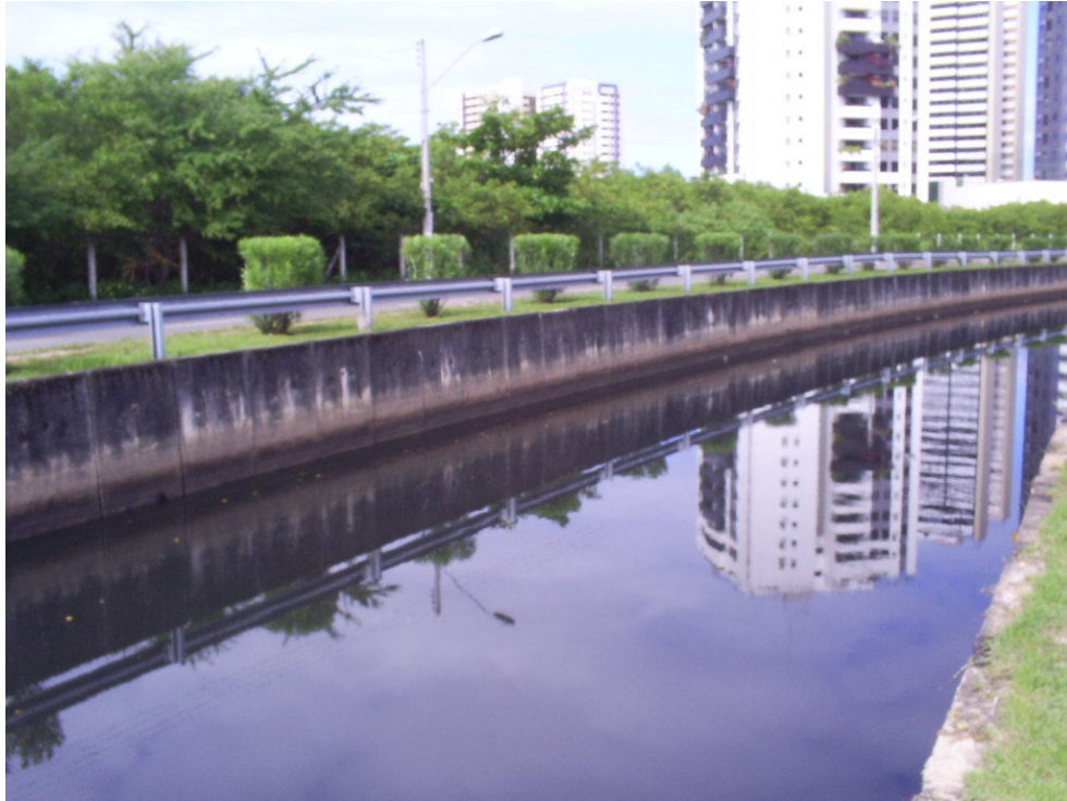
Figura 8: Canal extremamente poluído que escoia para Parque Tramanday.
