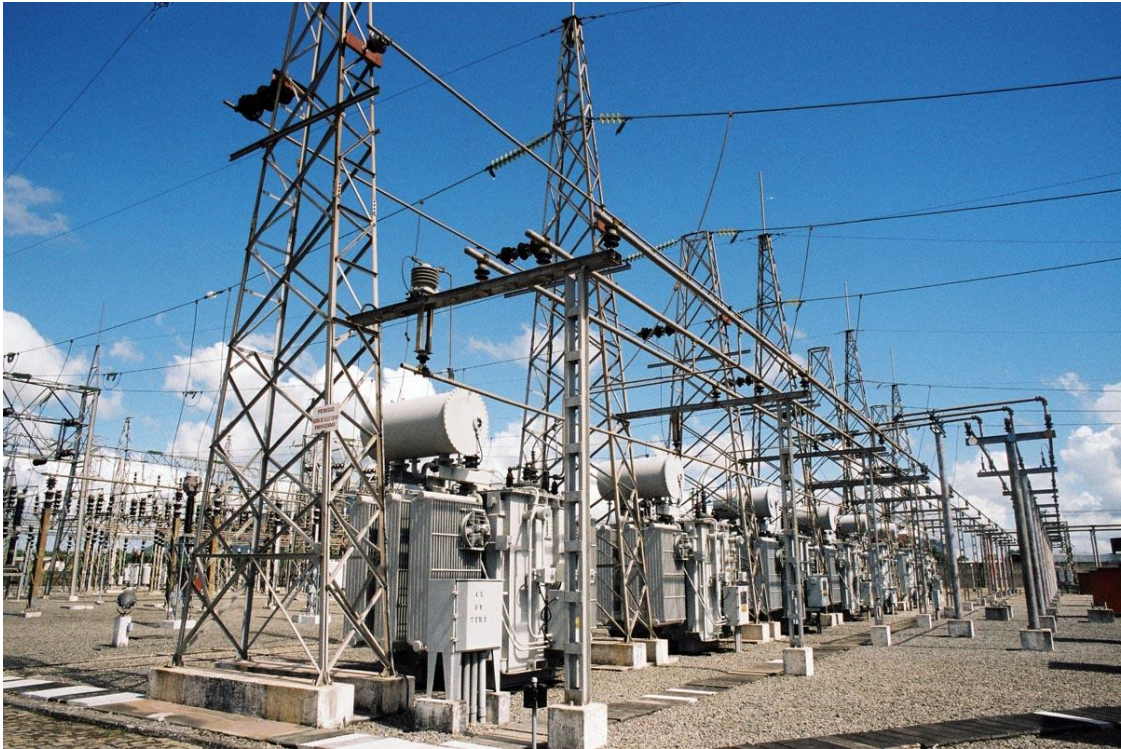
Figura 2: Subestação Eletrica de Suape
