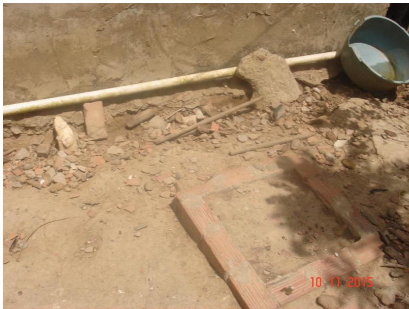
FIGURA 3.2 – Caixa de inspeção desativada Fonte: Aatoria própria
