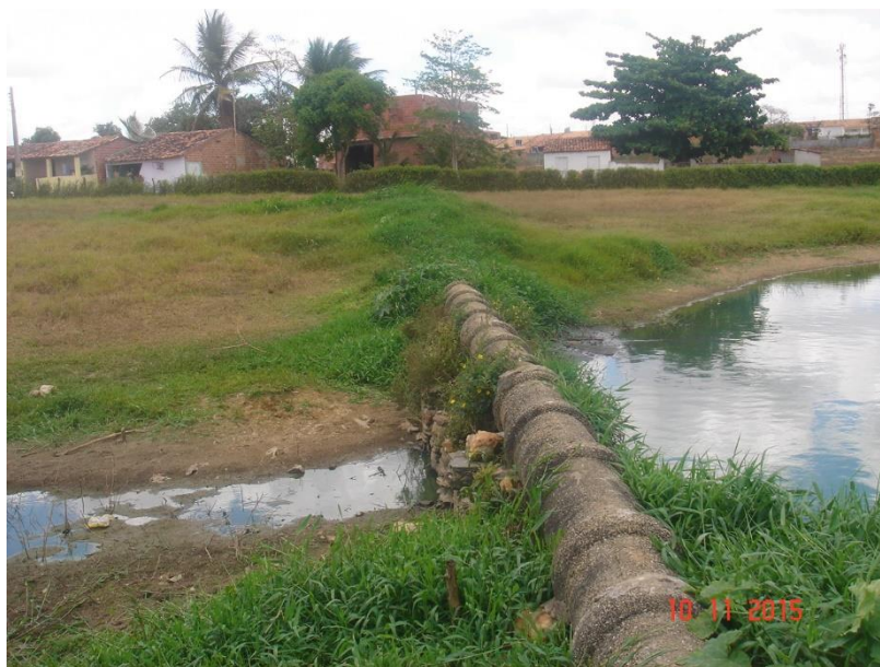
FIGURA 3.4 – Manilhas expostas Fonte: Aatoria própria
