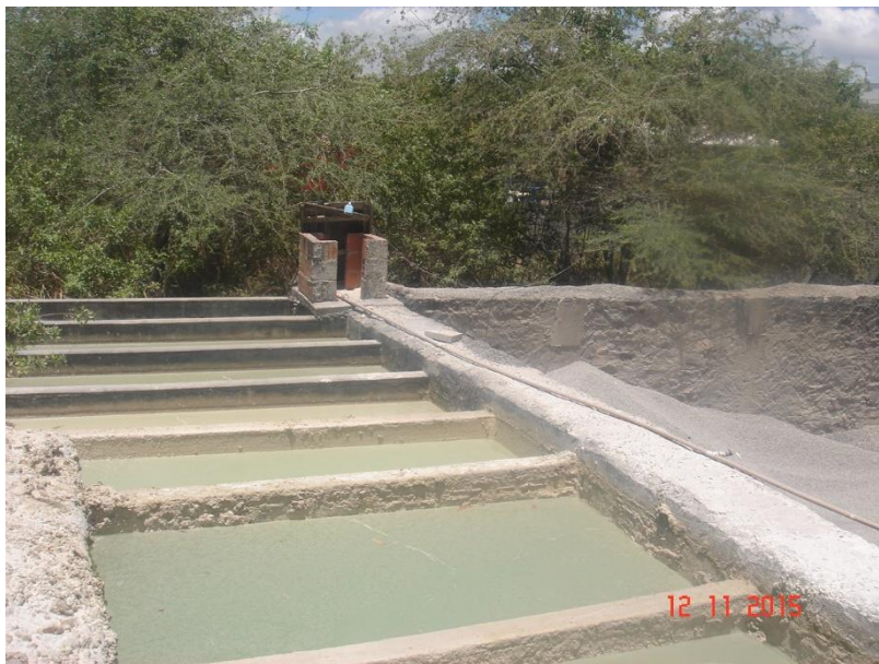
FIGURA 3.18 – Tanque de decantação. Fonte: Autoria própria
