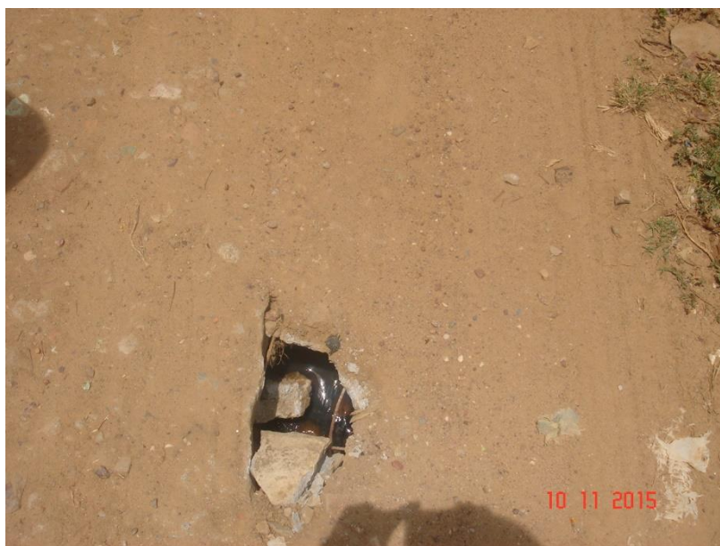
FIGURA 3.5 – Esgoto visível Fonte: Aatoria própria
