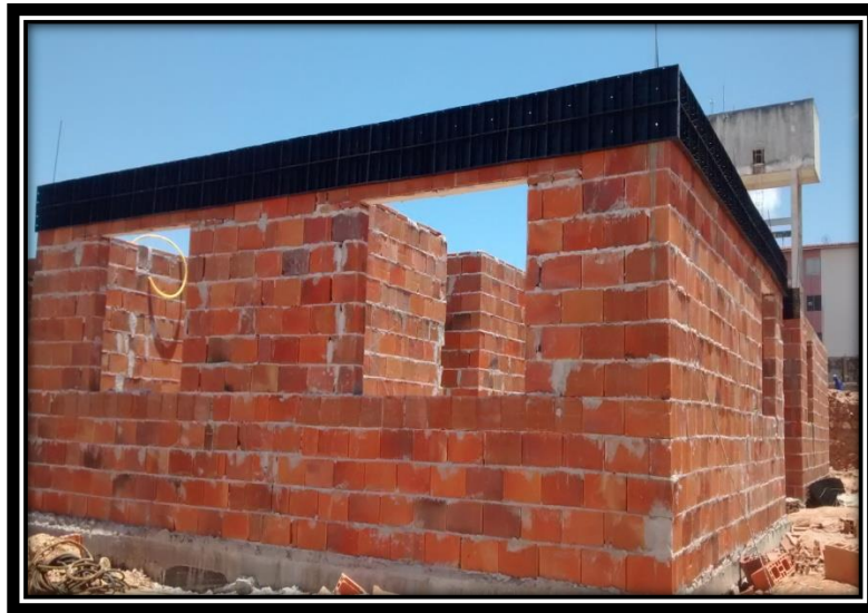
FIGURA 33. Argolamento sobre alvenaria estrutural
