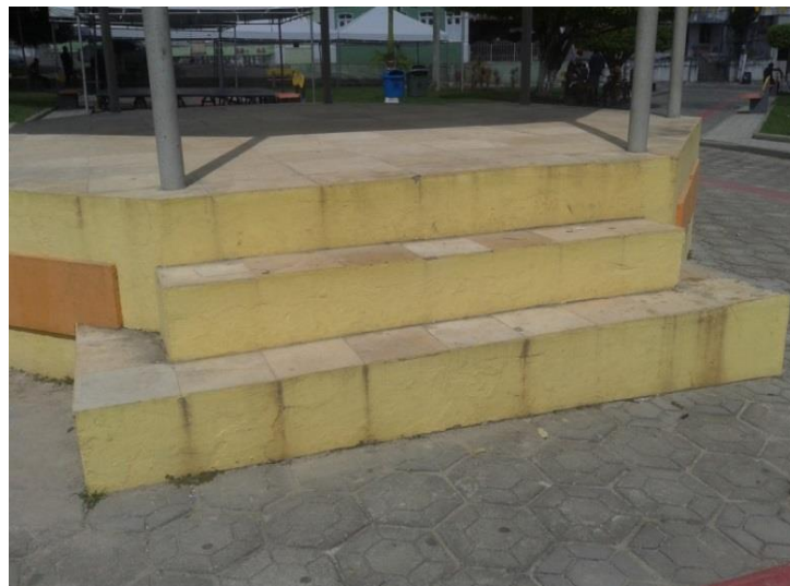
Figura 16. Escada com altura do espelho superior a 0,20m.
