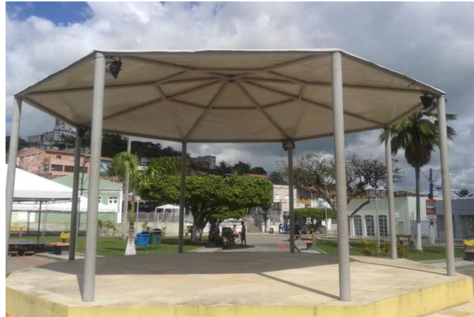
Figura 12. Inexiste guarda-corpo no Coreto.
