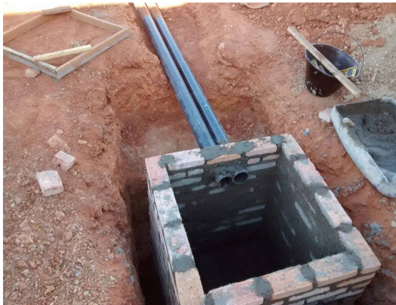
Figura 6: Caixa de passagem
