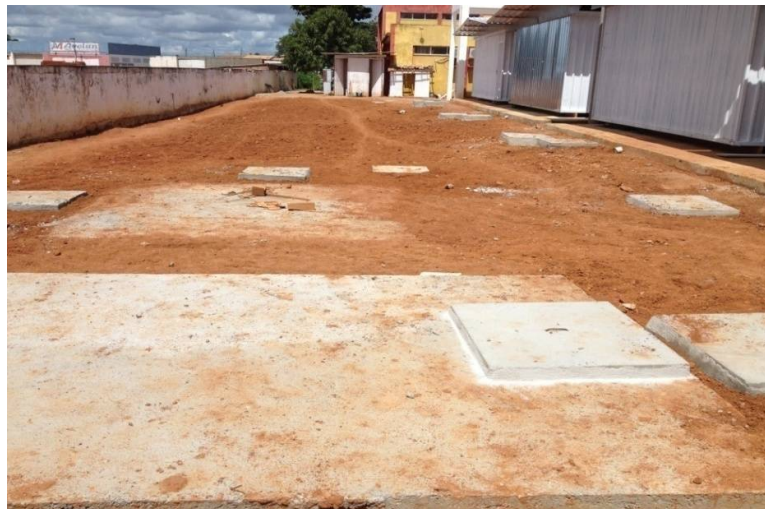
Figura 13: Acesso às caixas de inspeção, fossa, filtro e sumidouro
