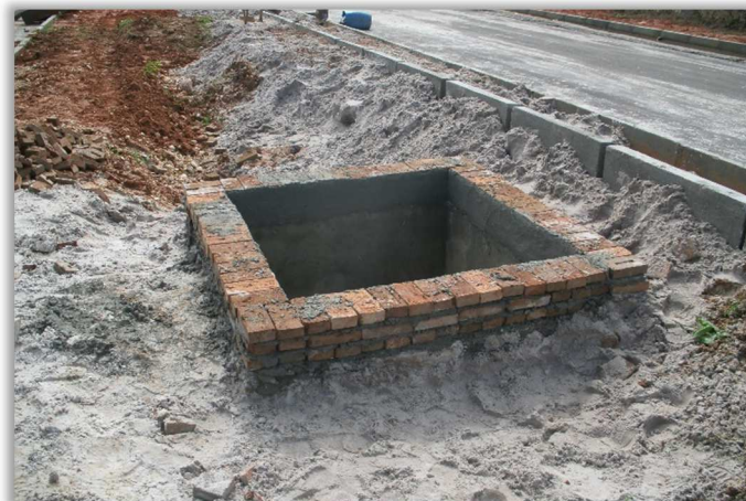
Figura 7 - Poço de Visita
