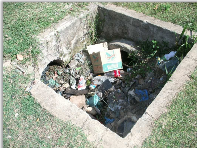
Figura 3 - Poço de Visita entupido com lixo pela própria população
