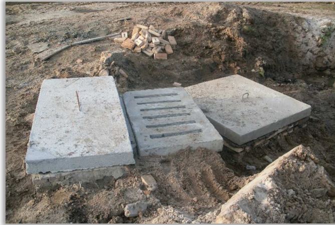
Figura 6 - Boca de Lobo e Caixa Cega
