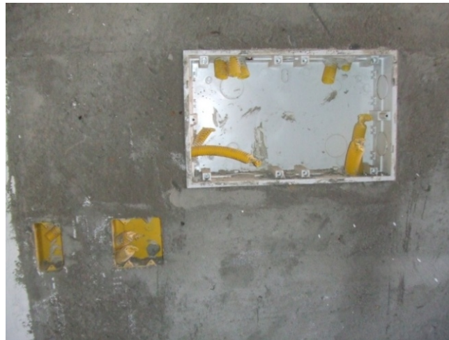
Figura 6 – Caixa de área fria
