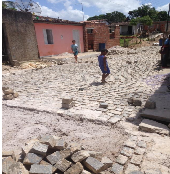
Figura 1: Recuperação de pavimentação em paralelepípedo de diversas ruas do bairro Roque Mendes
