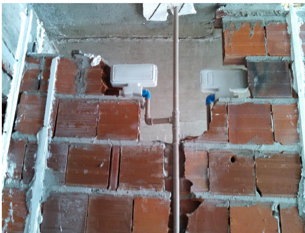
Figura 10: Passagem de caixa polar para ar-condicionado.
