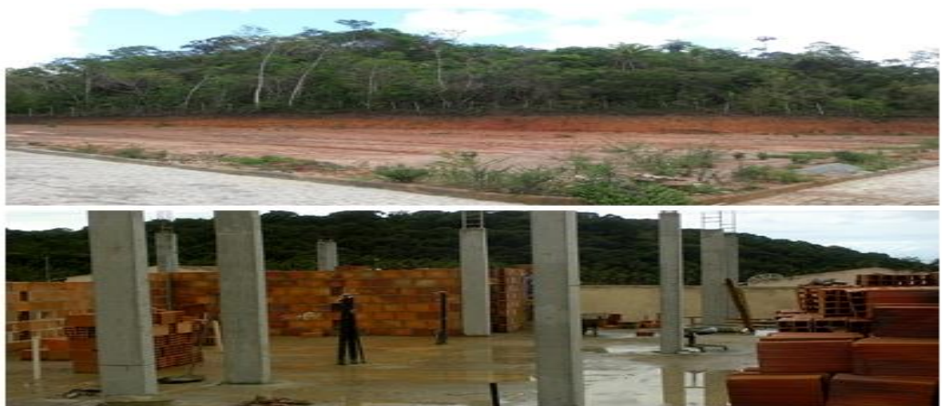
Figura 2: Terraplanagem, pilares locados e concretados, iniciam da alvenaria de bloco. Fonte: UBS Genelice Oliveira de Santana, 2015.
