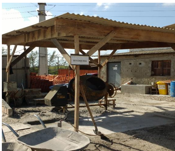
Figura 9 - Central de Concreto.
