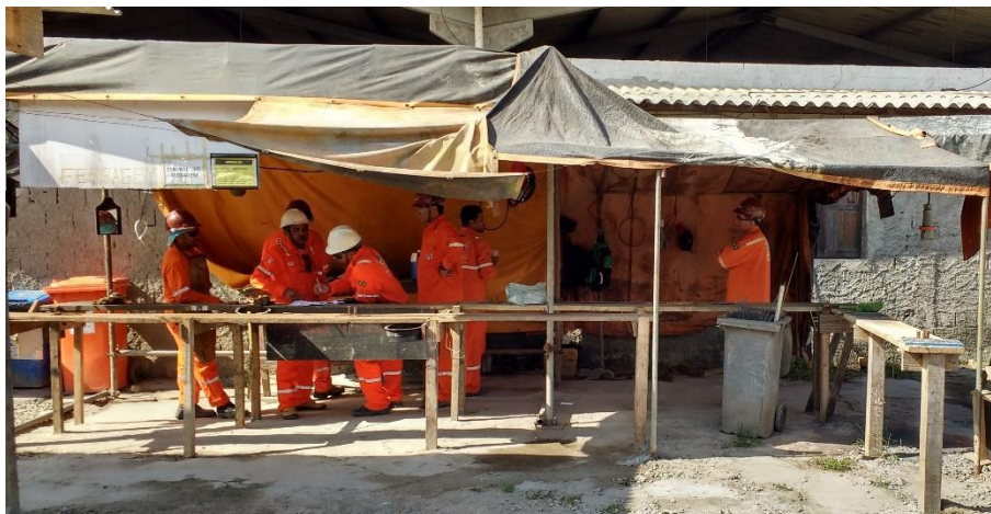
Figura 10 - Central de Ferragem.
