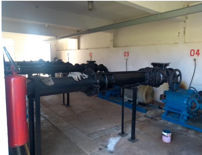
Figura 1 – Conjunto de motobombas.
