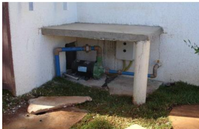
Figura 08: Bomba do Sistema de Irrigação.
