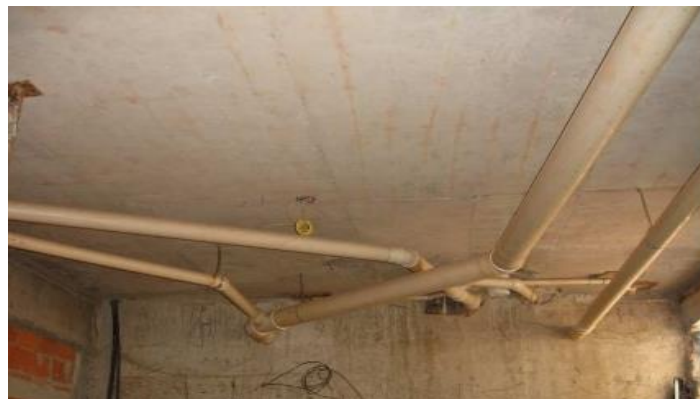
Figura 07: Tubulação proveniente da laje de cobertura seguindo até o reservatório inferior.
