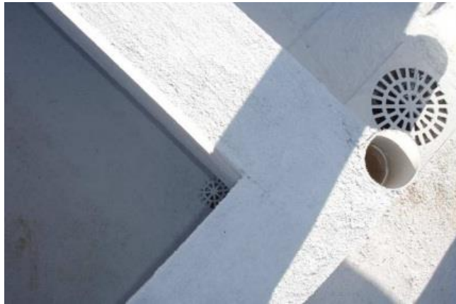
Figura 05: Os ralos instalados na laje cumprem a função do filtro, separando as sujeiras mais grossas.
