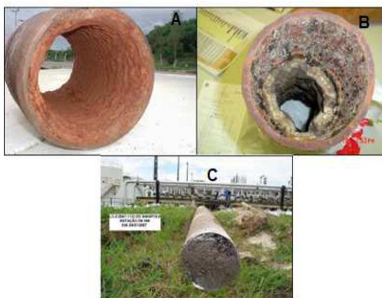
Figura 2: Incrustação de BaSO_4 parcial (A), média (B) e total (C) de uma linha de 6 polegadas (GOMES et al., 2011).
