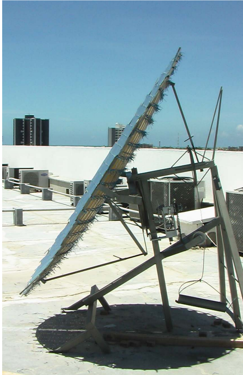
Figura 3.119. Concentrador solar com sistema de pêndulo.
