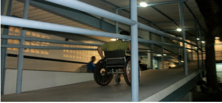
Fotografia 12: Senhor Alessandro nas rampas inadequadas da UNIT Fonte: Fotógrafa Aritana Conceição Ferreira Divino
