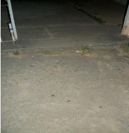
Fotografia 3: Buracos no piso da escola Fonte: Fotógrafa Aritana Conceição Ferreira Divino
