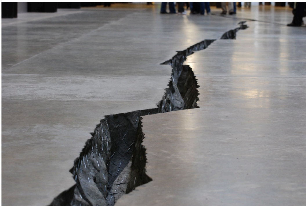
Imagem 01 - Shibboleth 15 : a rachadura exposta
