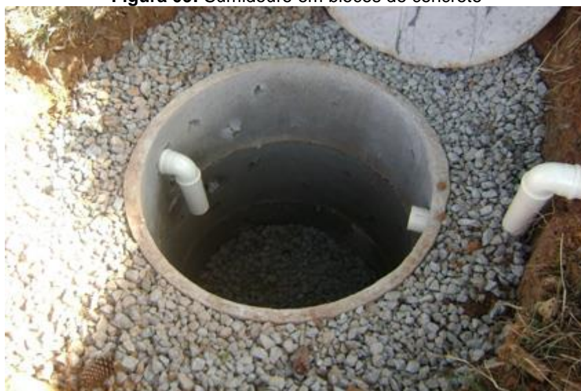
Figura 09: Sumidouro em blocos de concreto
