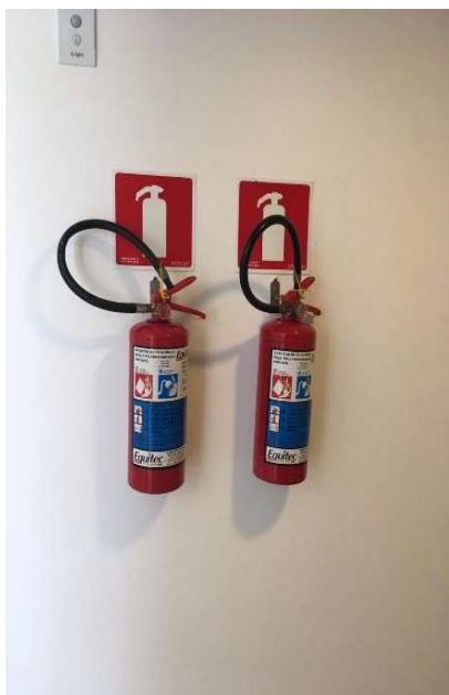
Figura 42 – Extintores de incêndio
