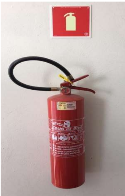
Figura 37 – Extintor de incêndio
