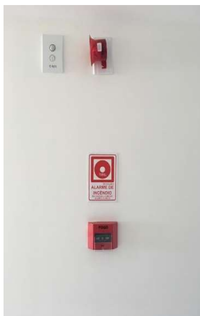
Figura 45 – Alarme de incêndio
