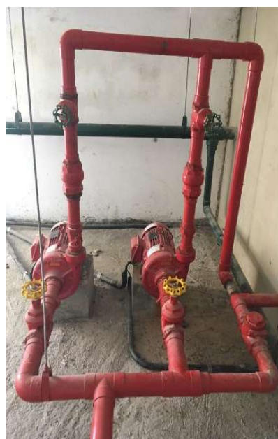
Figura 41 – Bombas de incêndio
