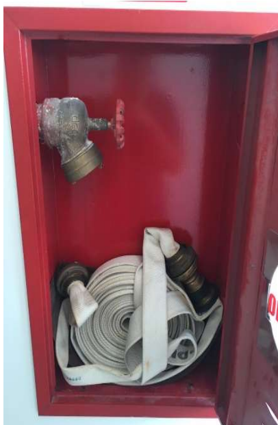
Figura 40 – Sistema de hidrantes
