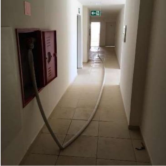
Figura 35 – Sistema de hidrantes
