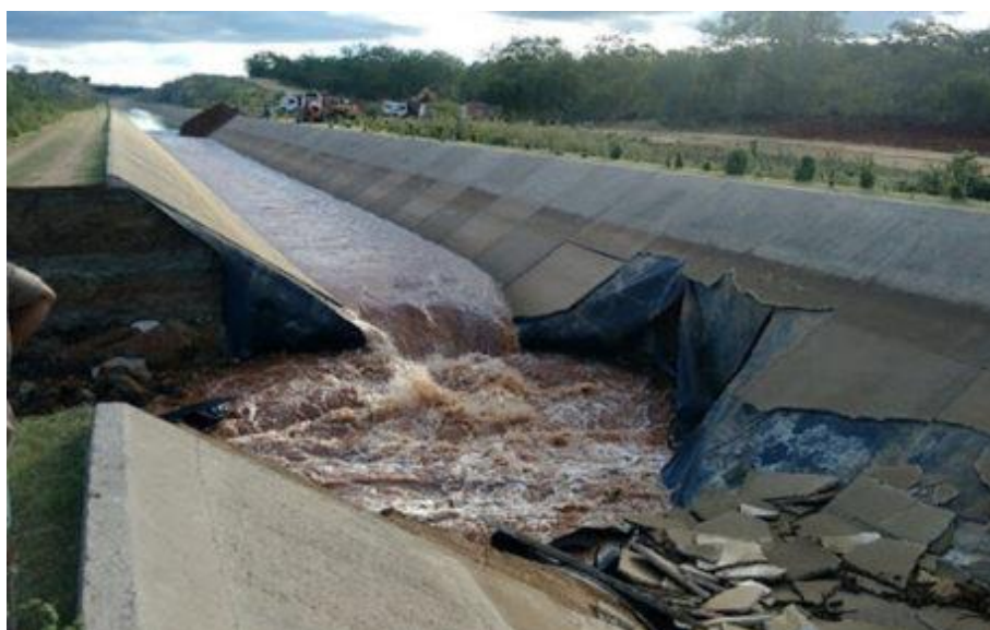
Figura 17: Rompimento do Canal de transposição do Rio São Francisco em Custódia.
