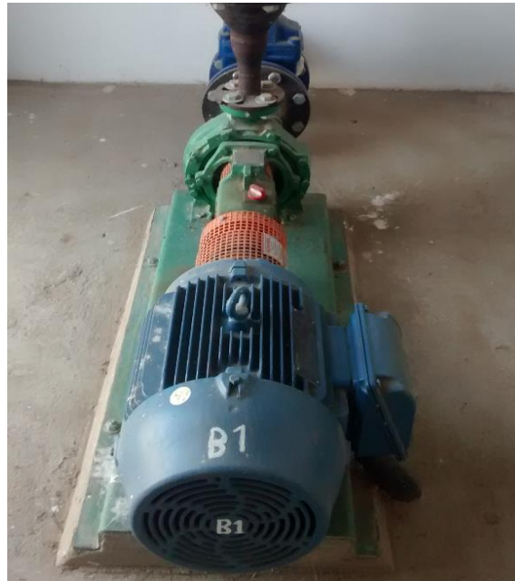
Figura 28: Bomba 1 da Estação Elevatória 1.
