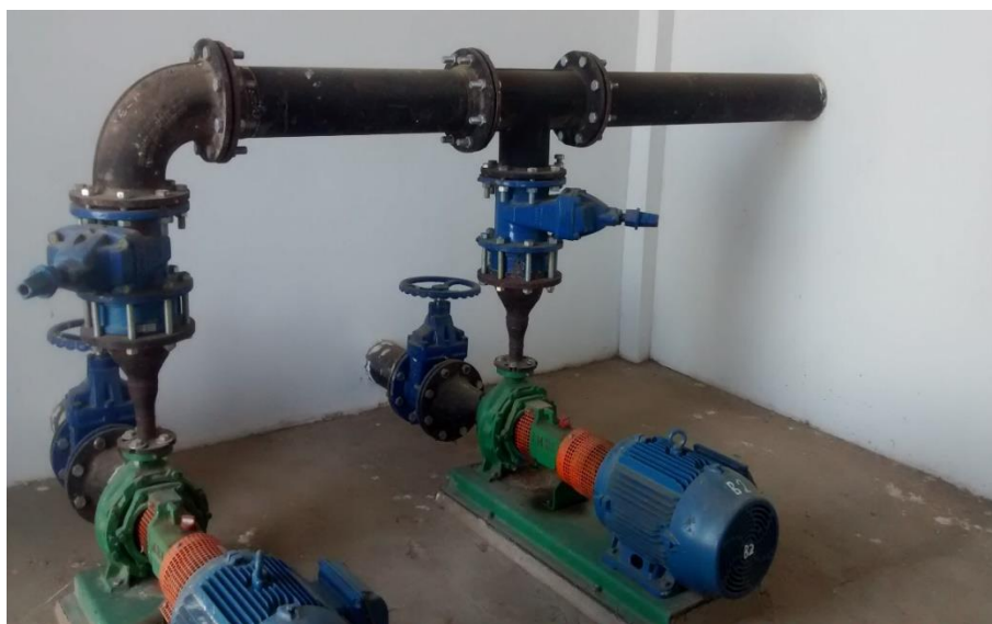
Figura 27: Bomba 1 e 2 ligadas à adutora do sistema.
