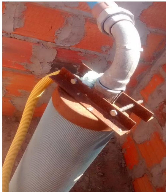
Figura 35: Poço artesiano localizado na região de implantação do sistema.
