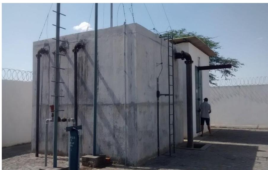
Figura 23: Poço 1 ao lado da caixa de bombas.
