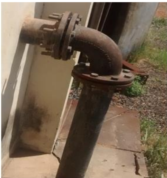
Figura 40: Tubulação atingida pela corrosão.
