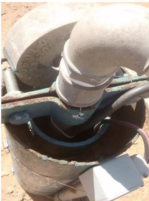
Figura 37: Poço 2 descoberto e com tampa solta.
