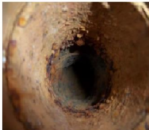
Figura 41: Adutora atingida por corrosão.
