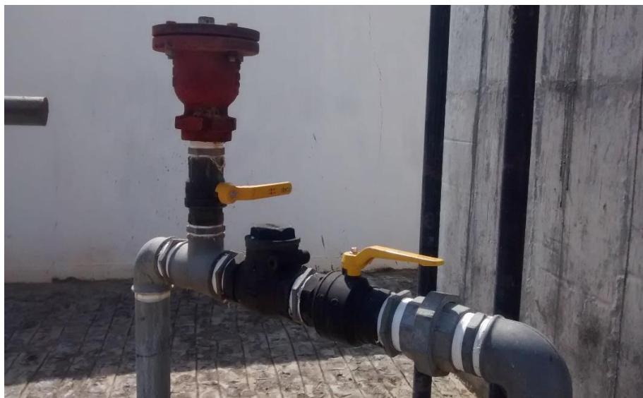
Figura 25: Válvulas de esfera acopladas na encanação do Poço 1.
