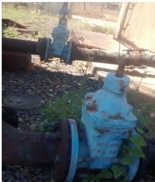
Figura 30: Válvulas de esfera na tubulação anterior ao reservatório.
