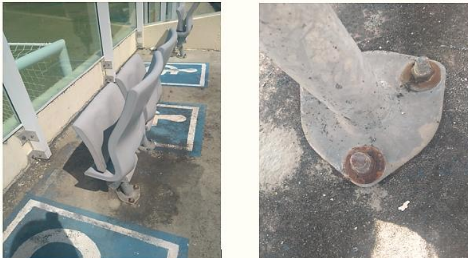
Figura 21 - A) Cadeiras próximo a área de deficiente. B) Corrosão nos parafusos das cadeiras.
