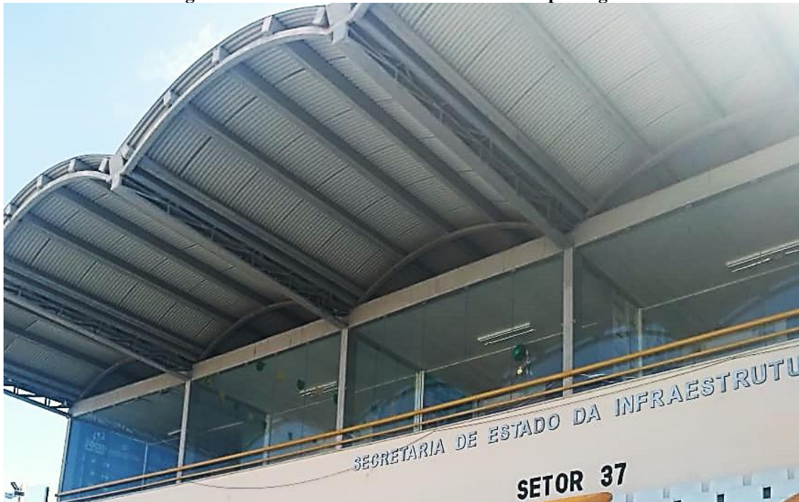
Figura 18 - Cobertura do estádio onde estão as patologias.
