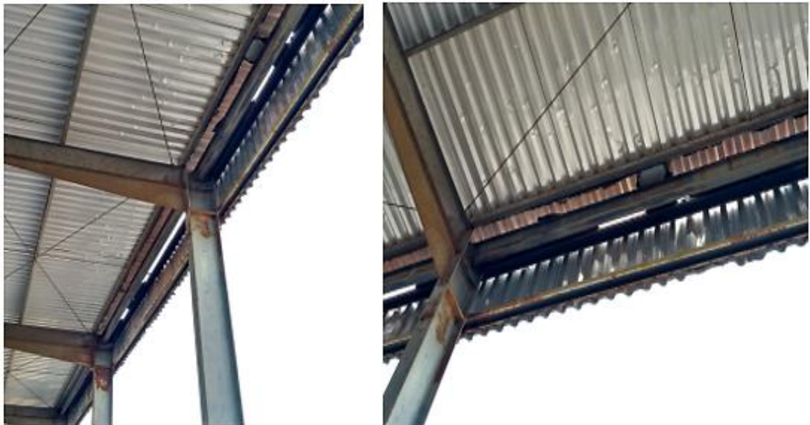
Figura 28 - A) Encontro da viga com o pilar. B) Pontos de corrosão.
