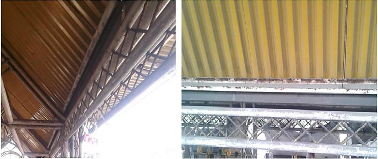
Figura 17 - A) Fundo da treliça com corrosão e B) Frente da treliça que também apresentam corrosões.
