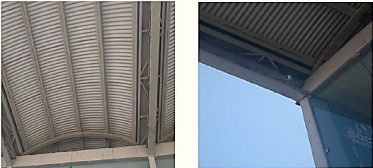
Figura 19 - A) Cobertura do estádio onde estão as patologias e B) Detalhes das patologias.
