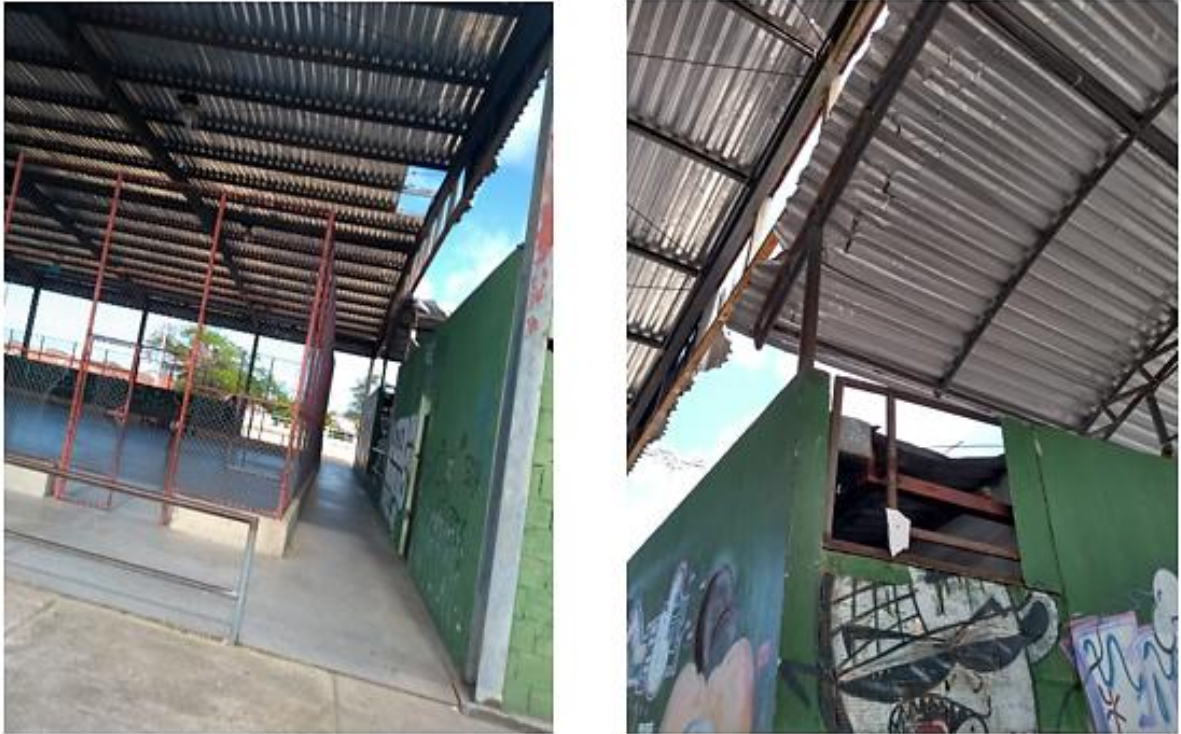
Figura 27 - A) Uma das entradas da quadra onde o telhado está comprometido. B) Vista superior das proximidades onde o telhado está comprometido.
