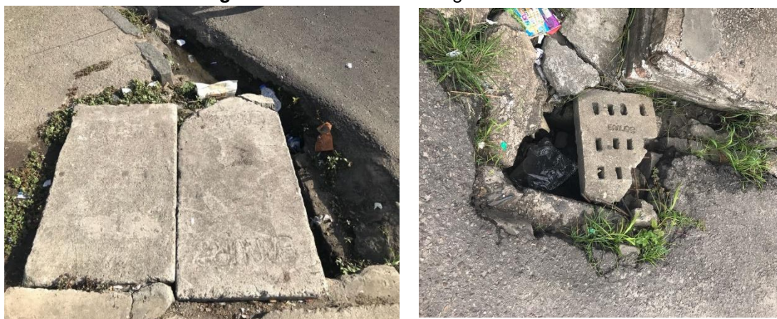
Figura 32 - Sistema de drenagem danificado.
