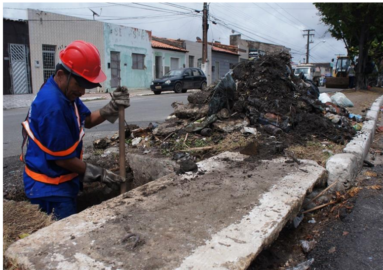
Figura 4 – Resíduos encontrados em uma boca de lobo em Aracaju.
