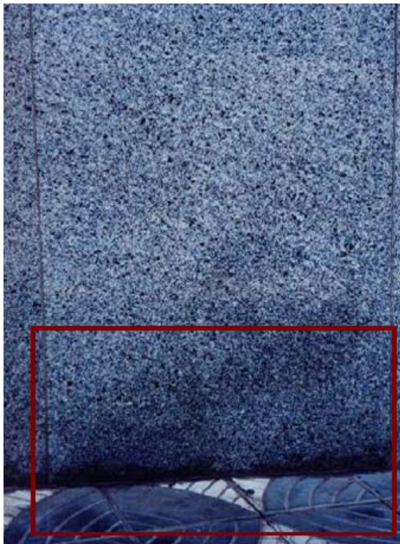
Figura 10 – Manchas sobre revestimento pétreo devido a presença de umidade no substrato
