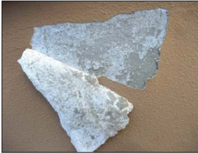
Figura 16 – Exemplo de descascamento em pintura.
