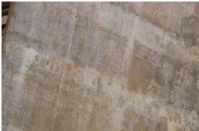
Figura 18 – Manchas esbranquiçadas presentes no revestimento
