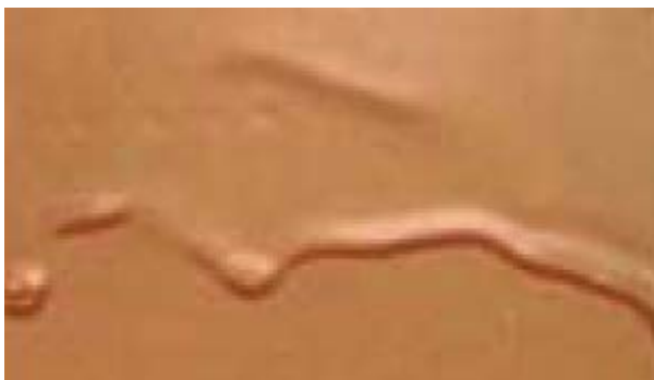
Figura 19 – Presença de enrugamento em pinturas
