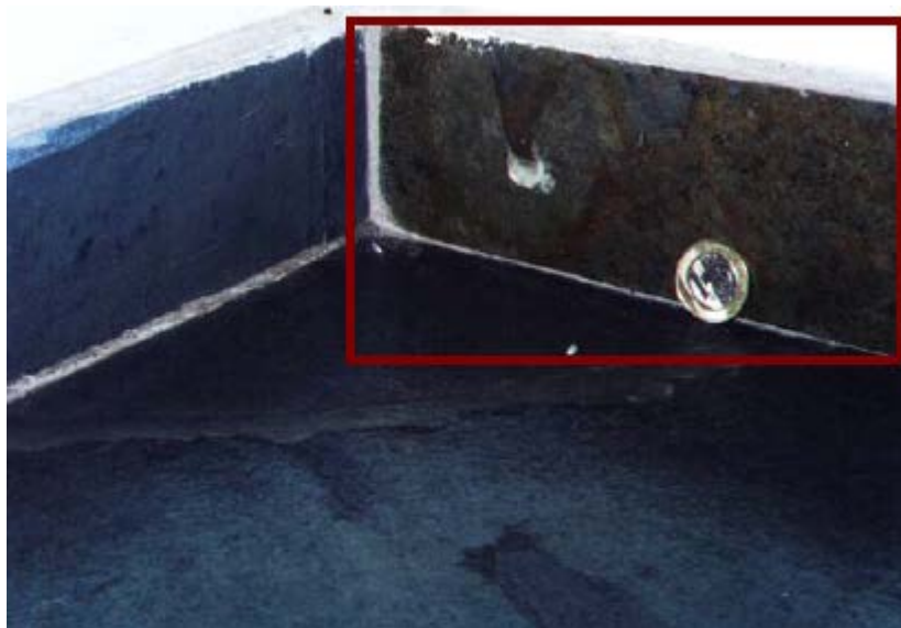
Figura 12 – Mudança de tonalidade de uma placa de ardósia devido a oxidação de minerais ferrosos
