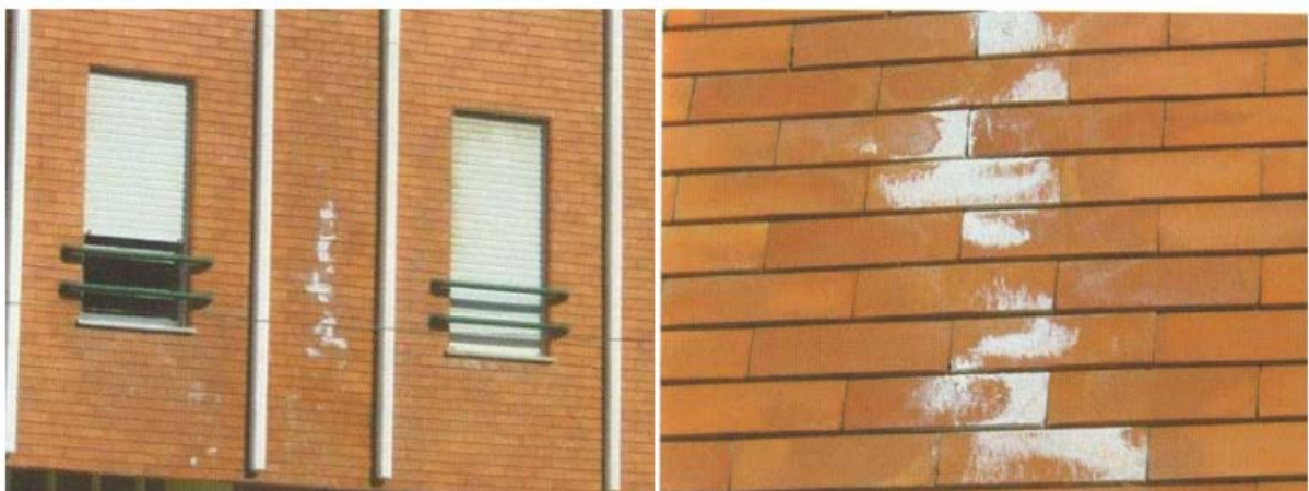
Figura 9 – Patologia em revestimento cerâmico: Eflorescência
