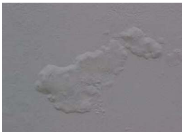
Figura 14 – Surgimento de bolha devido a umidade no substrato.
