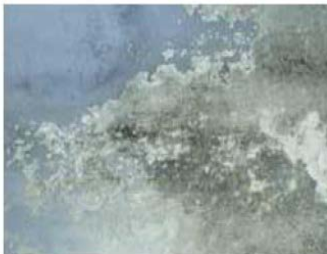
Figura 15 – Superfície com revestimento por pintura que sofreu o processo de eflorescência.
