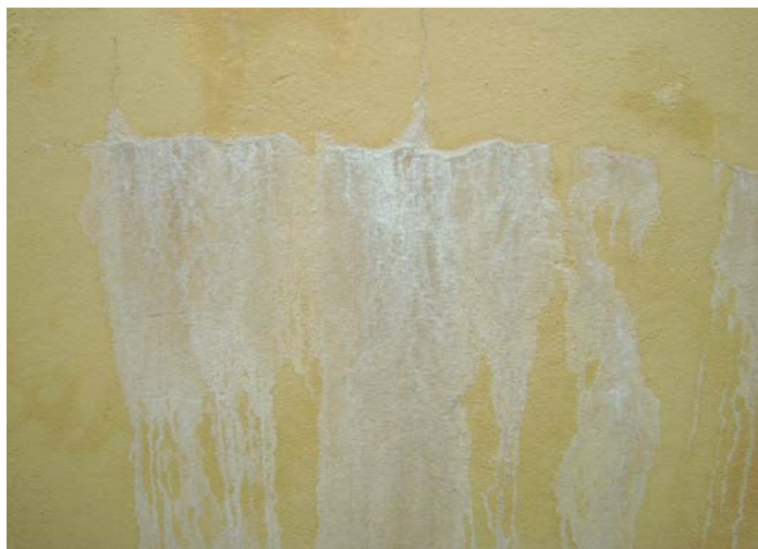
Figura 6 – Exemplo de eflorescência em revestimento argamassado.
