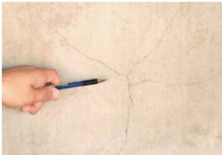
Figura 13 – Fissuração presente num revestimento por pintura
