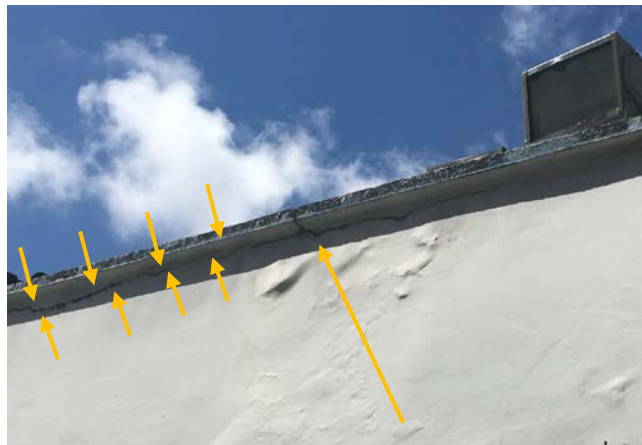
Figura 31 – Muro de divisa com vista de rufo do Banco Caixa Econômica Federal
