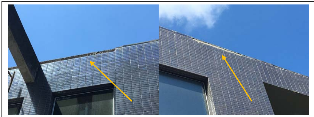
Figura 28 – Área de revestimento cerâmico que sofreu descolamento
