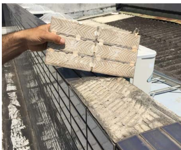
Figura 30 – Tardo de la placa cerâmica com ausência de argamassa colante
