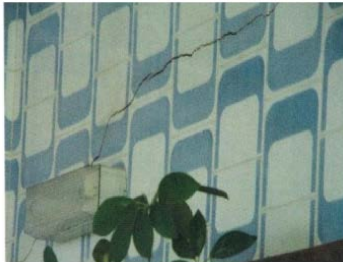
Figura 8 – Patologia em revestimento cerâmico: Fissuração
