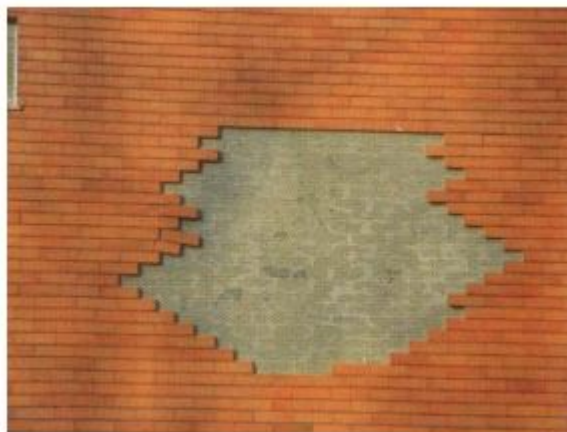
Figura 7 – Patologia em revestimento cerâmico: deslocamento
