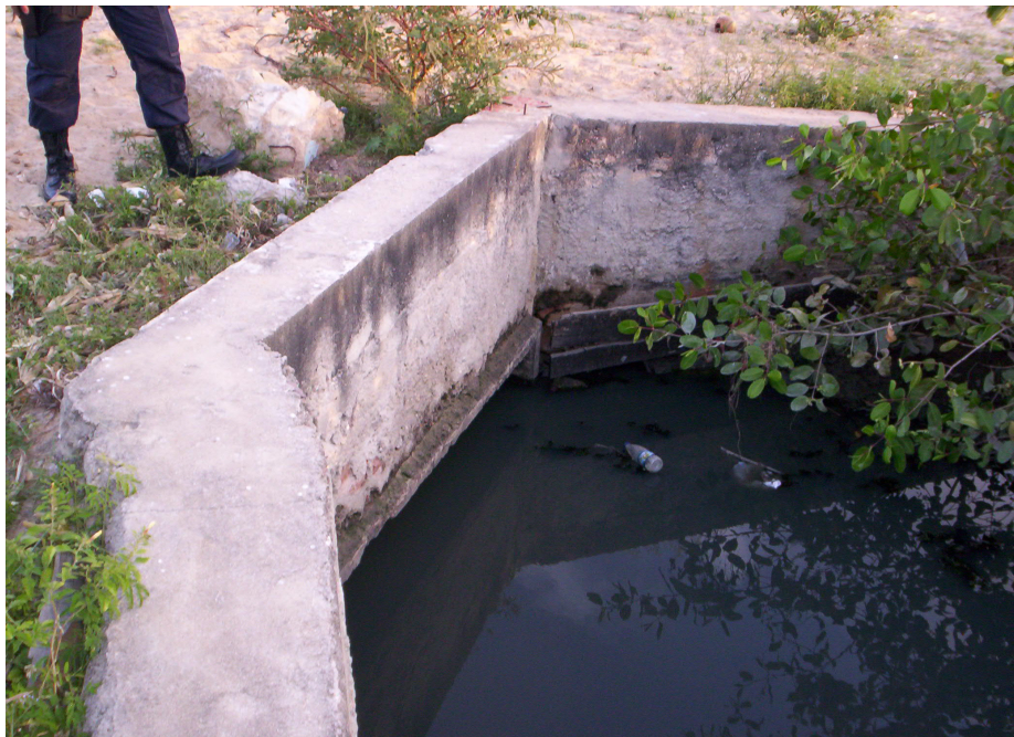
Foto 6 – Esgoto no Manguezal
