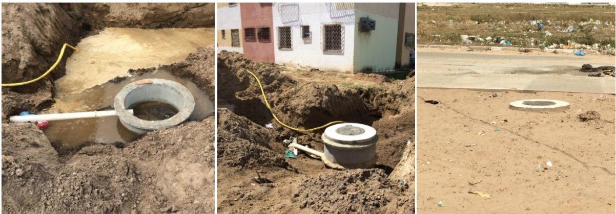
Figura 9, 10 e 11 - Execução de Poço de Visita –PV Fonte: Arquivo digital do autor (2015)
