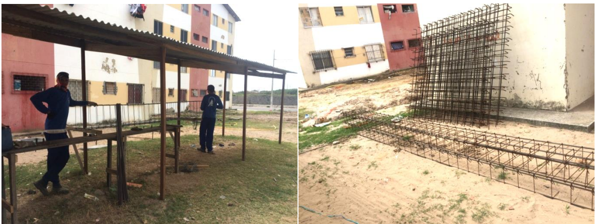
Figura 12 e 13 - Corte, dobra e montagem das ferragens para concretagem da caixa d'água Fonte: Arquivo digital do autor (2015)
