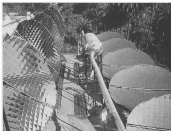
Figura 16: Instalação do módulo com 10 concentradores no Hospital Global, em Mount Abu. São observados concentradores em alturas diferentes, os receptores e o tanque principal, onde o vapor é armazenado (PAHISSA, 2014).
