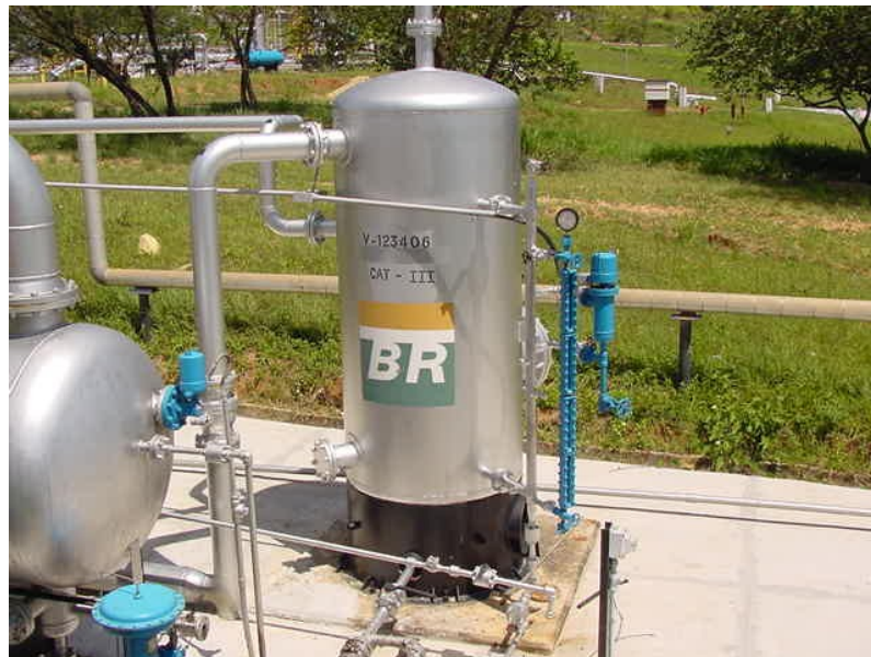
Figura 2 – Equipamento de processo da Unidade de Processamento de Gás Natural da UN-SEAL da Petrobras.
