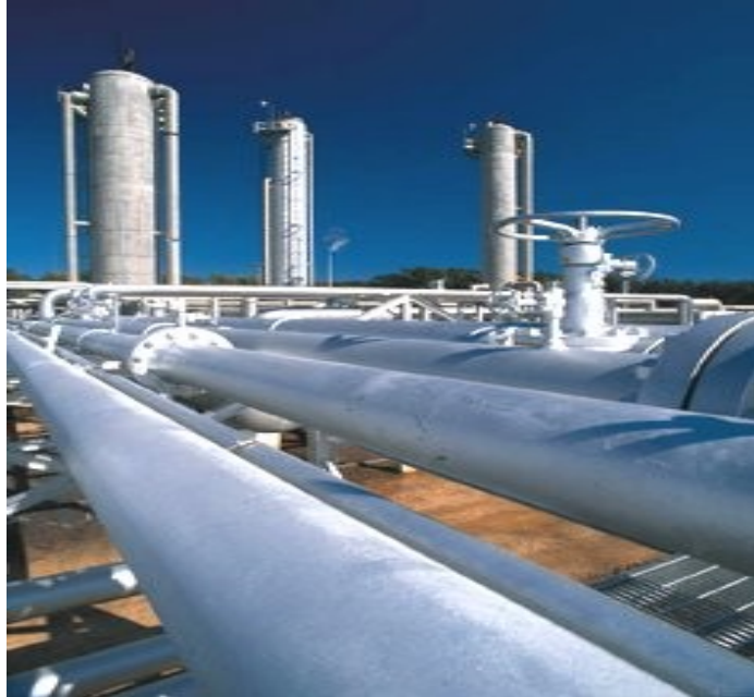
Figura 3 – Sistema de tubulações industriais da Unidade de Negócio Sergipe e Alagoas da Petrobras.
