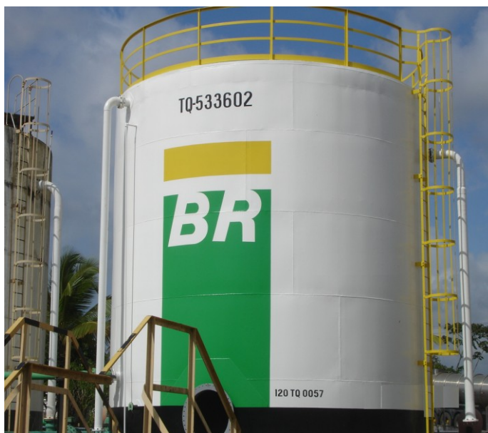
Figura 1 – Tanque de armazenamento de petróleo da Unidade de Negócio Sergipe e Alagoas da Petrobras.
