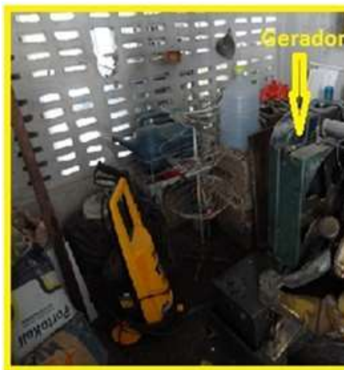
Figura 83 – área de gerador de energia obstruído. Fonte: O Autor
