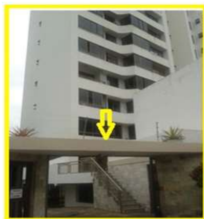
Figura 14 – Portal de entrada de condomínio com impedimento de acesso para os Bombeiros. Fonte: o autor
