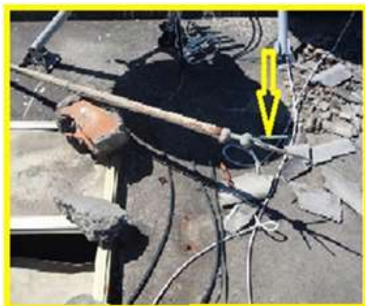
Figura 20 – Haste do para-raios danificada Fonte: o Autor
