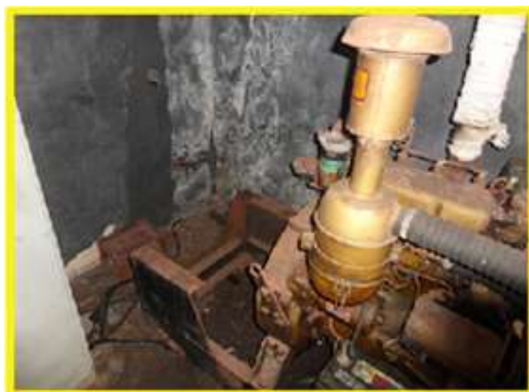
Figura 43 – Gerador danificado encontrado em condomínio vertical. Aracaju.
