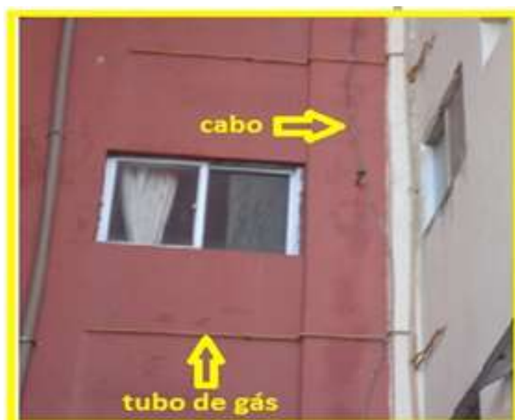
Figura 21 – cabo de aterramento do para-raios cruzando com a tubulação de gás. Fonte: o Autor
