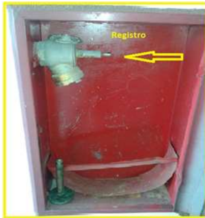
Figura 67 – Caixa com o registro de hidrante danificado Fonte: O Autor
