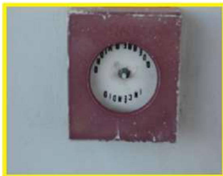
Figura 53 – Botoeira danificada encontrado em condomínio vertical em Aracaju. Fonte: O Autor
