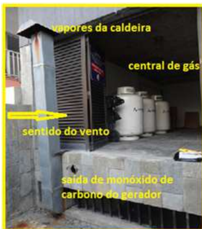
Figura 44 – Gerador mal posicionado com emissão de gases em local inadequado. Aracaju Fonte: O Autor
