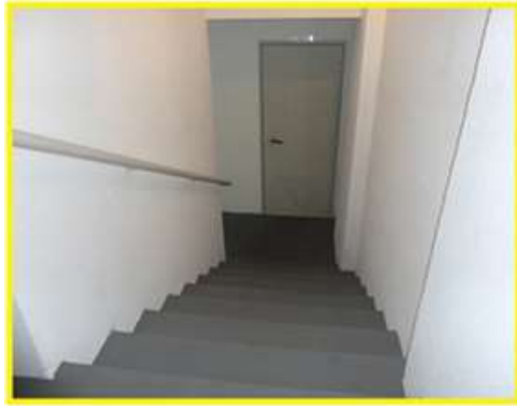
Figura 41 – Escada de emergência com corrimão apenas de um lado e intermitente Fonte: O Autor
