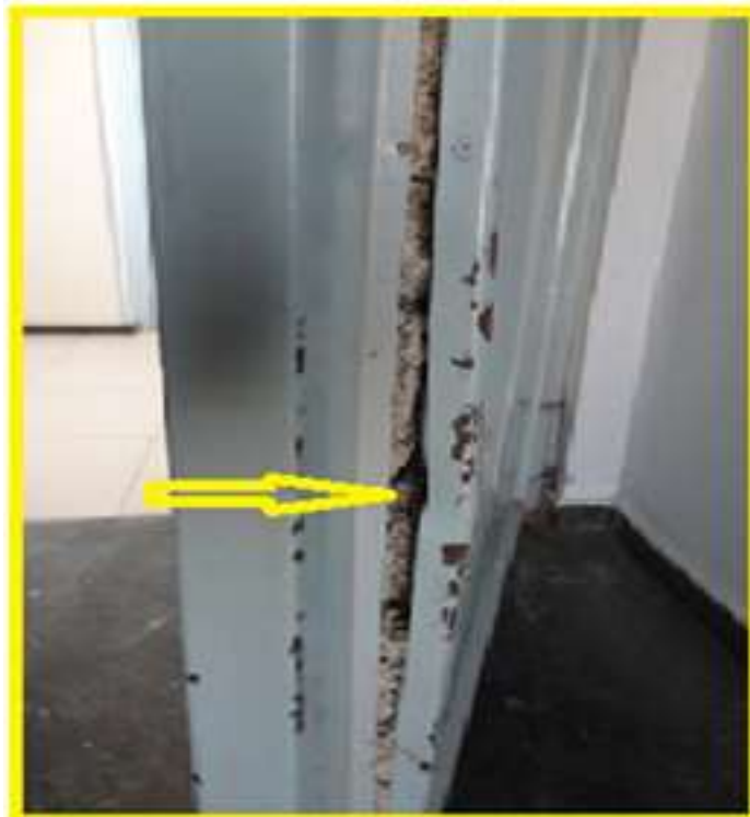
Figura 80 – Precariedade de uma porta corta-fogo encontrada em condomínio em Aracaju. Fonte: O Autor
