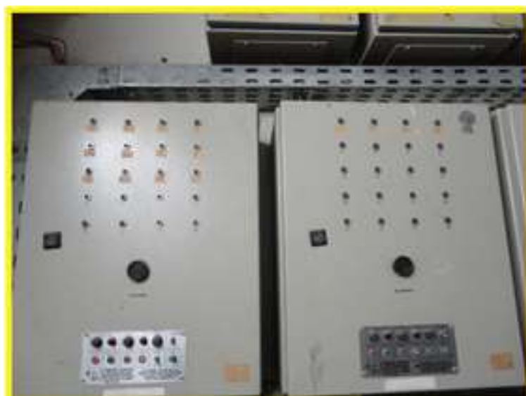
Figura 54– Central de alarme de incêndio encontrada desativada em prédio de Aracaju Fonte: O Autor
