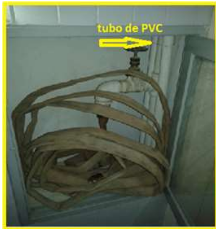
Figura 62 – Sistema hidráulico preventivo de combate a incêndio instalado em PVC, acoplado com mangueiras para incêndio ressecadas. Fonte: O Autor
