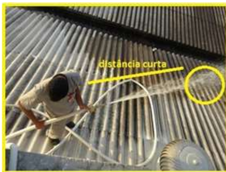
Figura 70– Teste do sistema hidráulico de combate a incêndio, com apresentação da bomba que não gerou pressão da água. Fonte: O Autor
