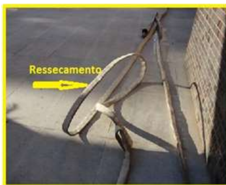
Figura 76 – Mangueira de combate a incêndio em condição de ressecamento.
