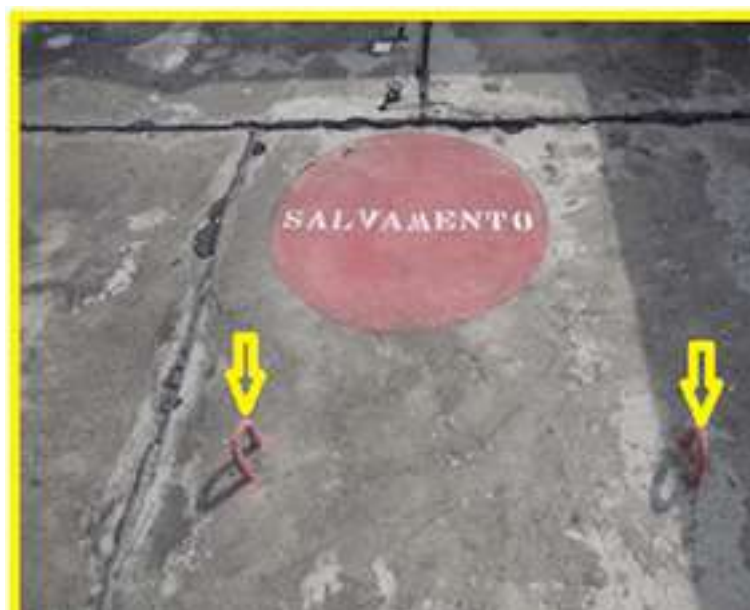
Figura 26 – Pontos de ancoragens estabelecidos no terraço do prédio, sinalizados e sem proteção às intempéries. Fonte: o Autor
