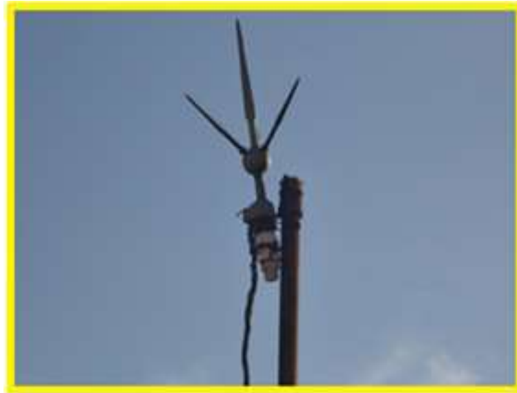
Figura 16 – Sistema de SPDA com o captor de raios quebrado da haste Fonte: O Autor
