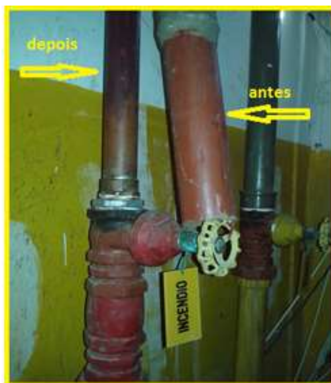
Figura 61 – Manutenção inadequada de um sistema hidráulico de combate a incêndio Fonte: O Autor
