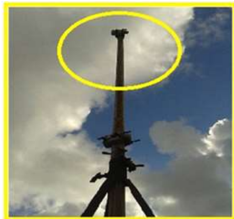
Figura 19 – Haste do para-raios sem os captadores Fonte: o Autor
